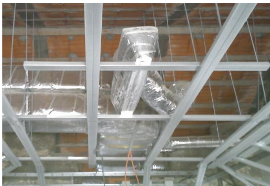
Figura.5-10 Pormenor da integração dos plenos na arquitetura do edifício
