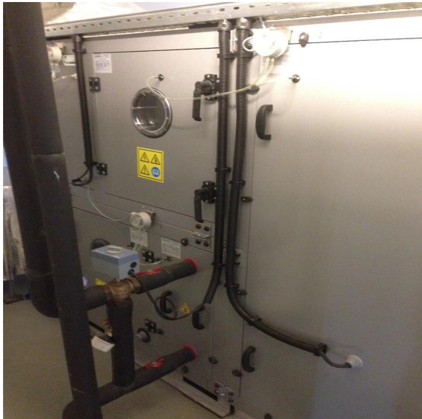
Figura 5-27 Ligação da instalação hidráulica à bateria da UTAN
