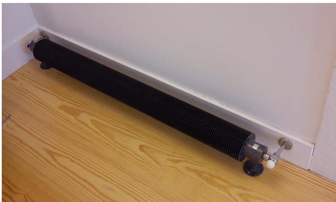
Figura 5-22 Radiador de chão aplicado RB1
