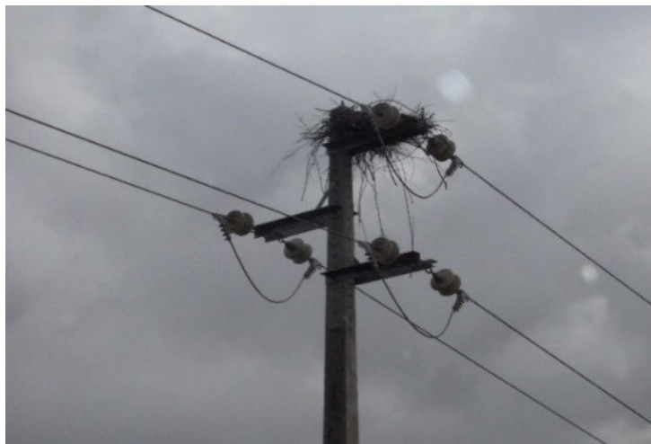
Figura 3.10: Linha de Média Tensão – cabo nu com ninho de cegonha.
