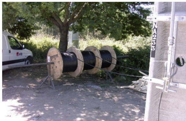
Figura 4.6: Bobinas do cabo Aerial Cable 15 kV.
