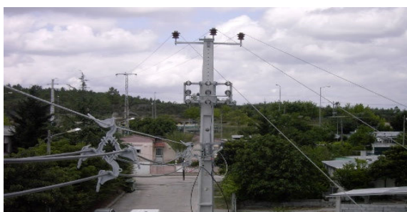
Figura 5.157: Seccionador lado A
