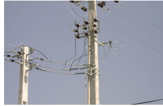
Figura 5.136: Ligeação de condutores.
