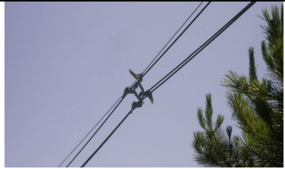
Figura 5.148: Condutores com espaçadores.
