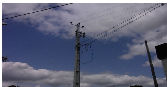
Figura 5.153: Seccionador lado A
