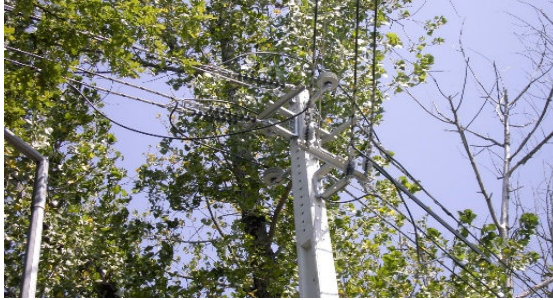
Figura 5.133: Ligeação de condutores.
