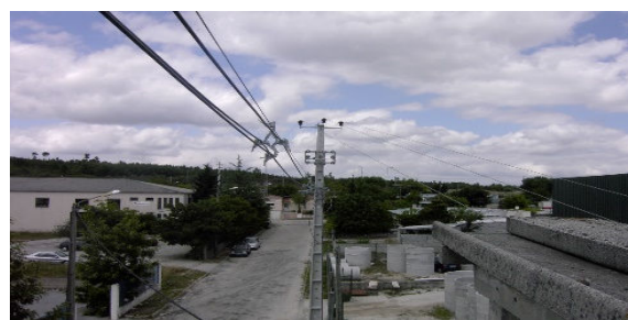
Figura 5.156: Seccionador lado A
