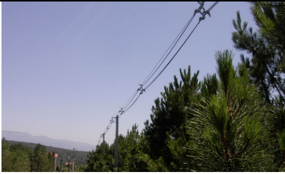
Figura 5.147: Condutores com espaçadores.
