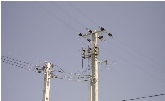
Figura 5.135: Ligeação de condutores.
