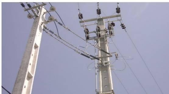
Figura 5.139: Ligeação de condutores.
