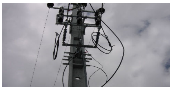
Figura 5.155: Seccionador lado A
