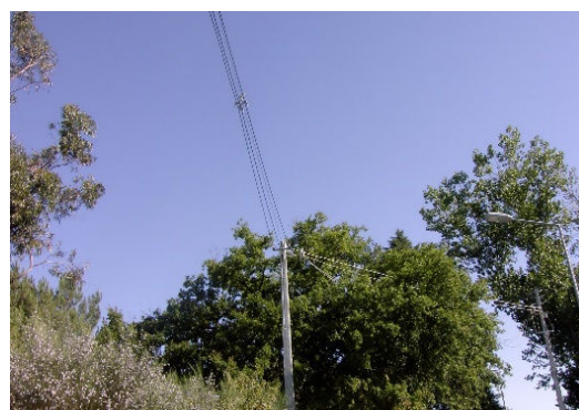
Figura 5.144: Condutores com espaçadores.
