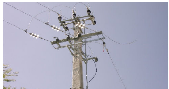
Figura 5.152: Seccionador lado B.
