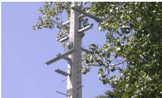
Figura 5.33: Travessas Montagem BD 35.
