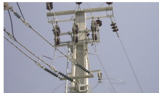
Figura 5.140: Ligeação de condutores.
