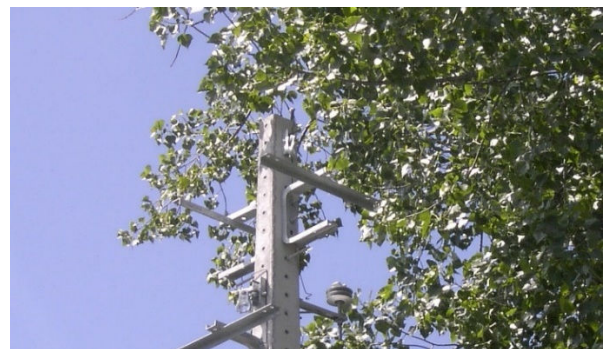
Figura 5.32: Travessas Montagem BD 35.
