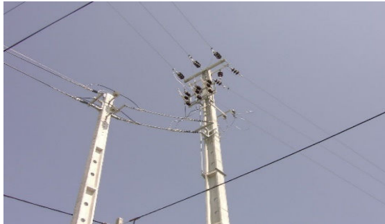
Figura 5.137: Ligeação de condutores.
