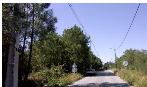
Figura 5.142: Condutores com espaçadores.
