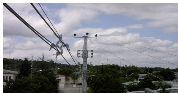
Figura 5.158: Seccionador lado A
