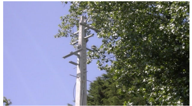
Figura 5.30: Travessas Montagem BD 35.
