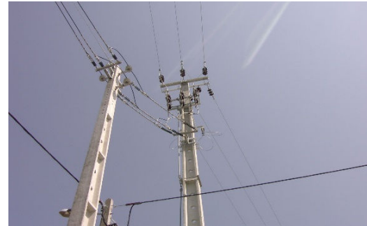
Figura 5.138: Ligeação de condutores.
