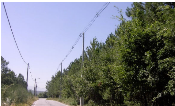
Figura 5.149: Condutores com espaçadores.
