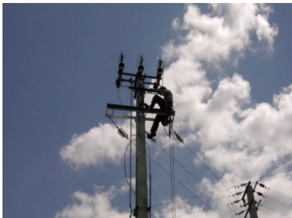
Figura 5.21: Travessas de Montagem.
