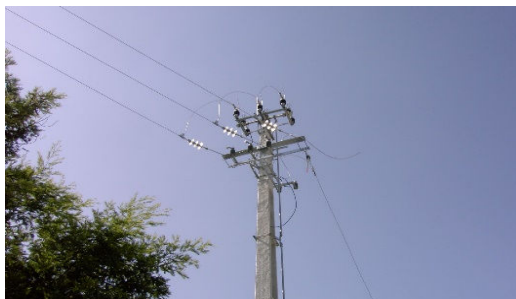
Figura 5.151: Seccionador lado B.
