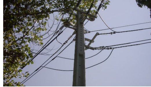
Figura 5.134: Ligeação de condutores.
