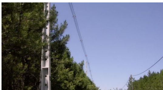
Figura 5.141: Condutores com espaçadores.
