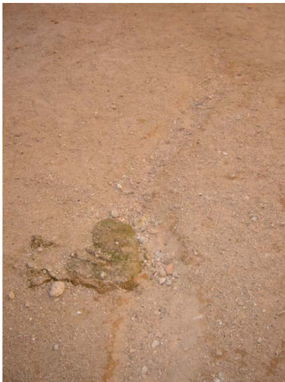
Figura 115. Pavimento interior do castelo com escavação provocada pelas águas das chuvas.
