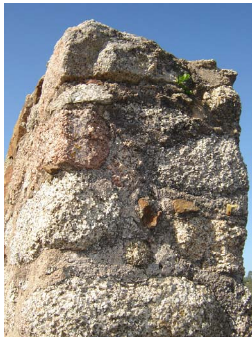
Figura 106. Evidências do fenómeno de erosão com o arredondamento das faces.
