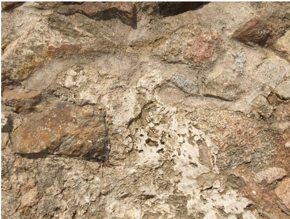
Figura 112. Aparecimento de eflorescências.
