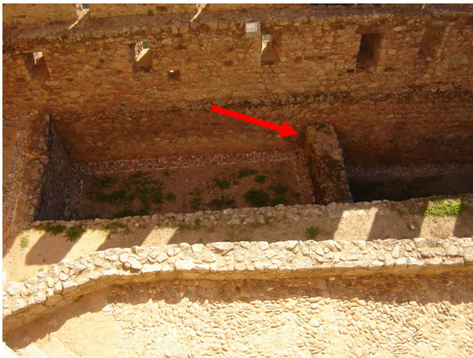
Figura 113. Necessidade de recalcamento de muros no interior das muralhas.
