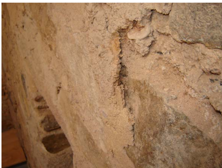
Figura 110. Queda de argamassas inapropriadas.
