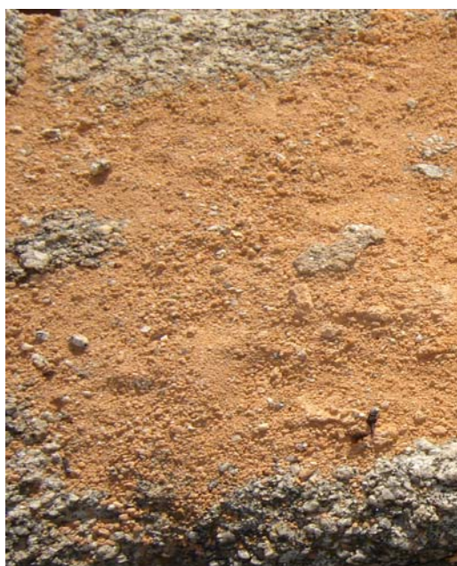
Figura 105. Evidências de arenização.
