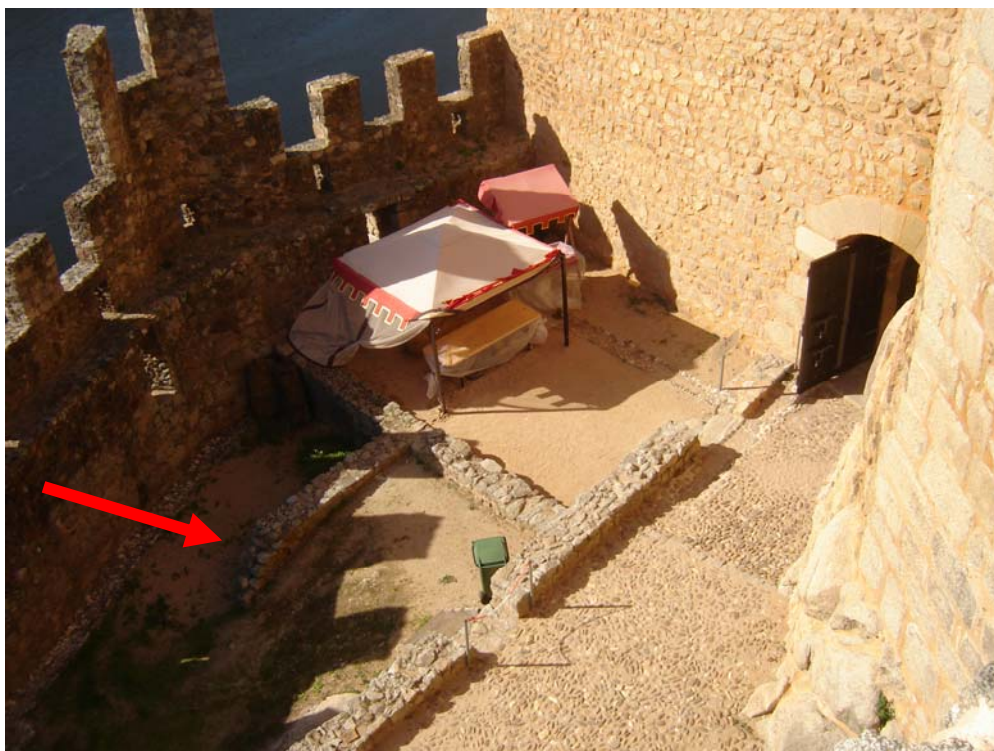
Figura 114. Muros no interior das muralhas, parcialmente caídos.
