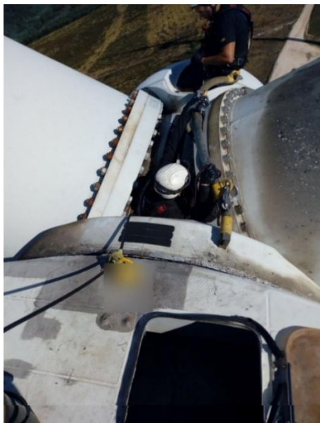
Figura 8 - Acesso aos Hub e ao Pitch de um aerogerador Ecotecnia Eco
