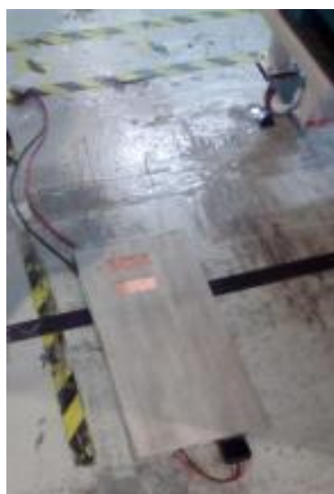
Figura 3 - Placas de cobre para carregamento de AGV's
