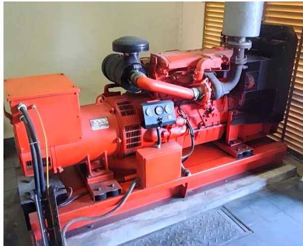
Figura 2.19 - Grupo gerador instalado no edifício
