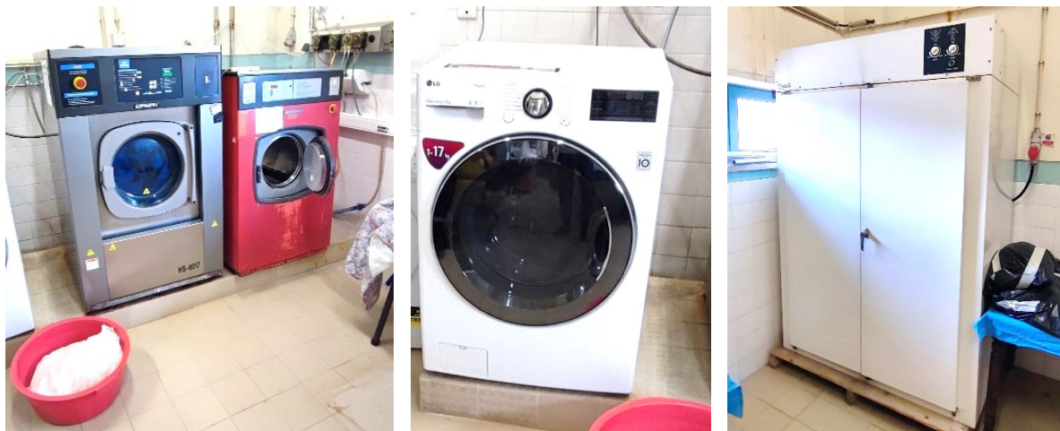
Figura 2.14 - Máquinas de lavar e de secar roupa instaladas no edifício
