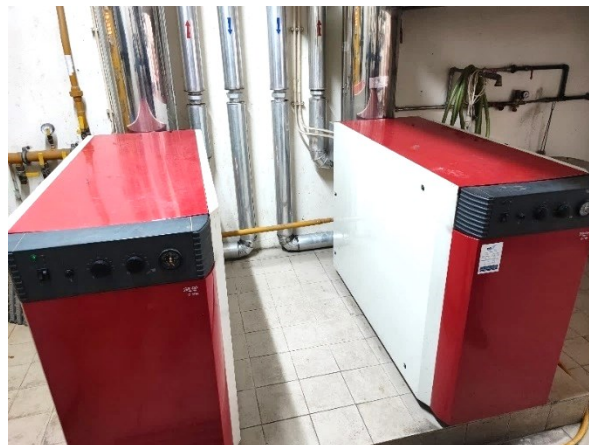
Figura 2.9 - Caldeiras de aquecimento a gás natural instaladas no edifício
