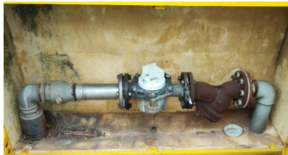
Figura 2.29 - Caixa de contador de água instalada no edifício
