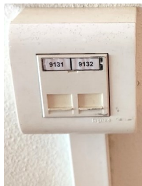
Figura 2.27 - Exemplo de tomada de pares de cobre instalada no edifício
