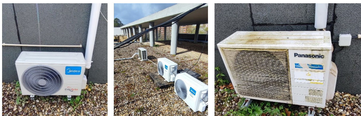
Figura 2.13 - Unidades de ar condicionado instaladas no edifício
