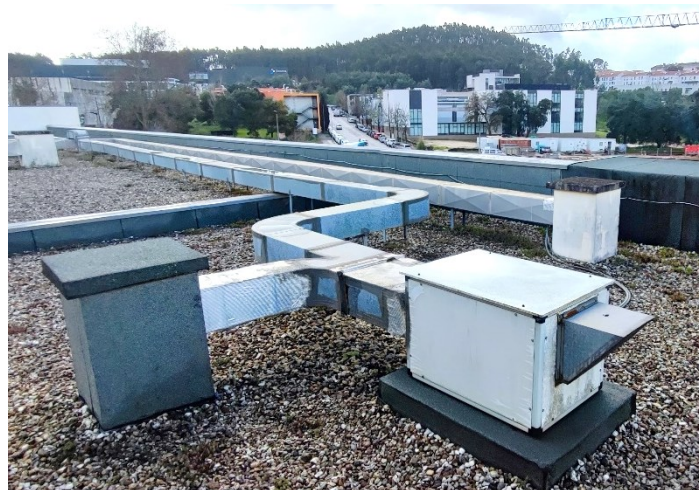
Figura 2.12 - Ventilador de extração instalado no edifício
