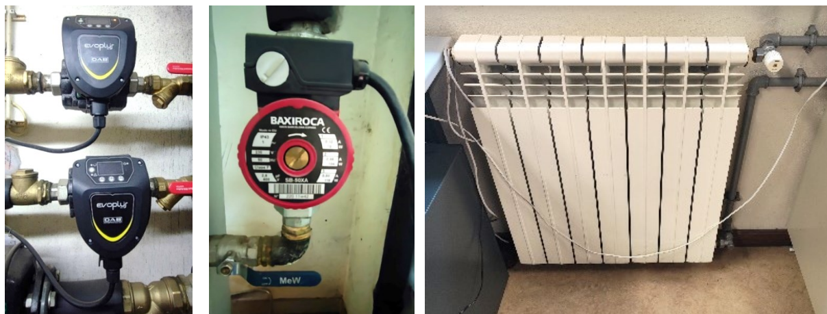
Figura 2.10 - Exemplo de eletrobombas e radiadores instalados no edifício
