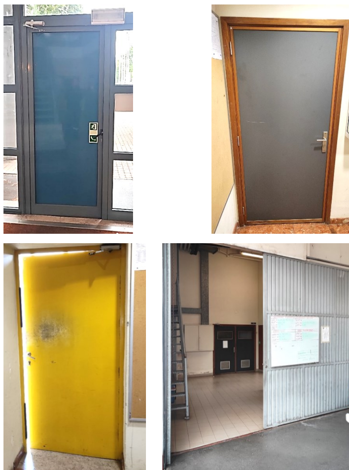
Figura 2.8 - Exemplos de portas instaladas no edifício
