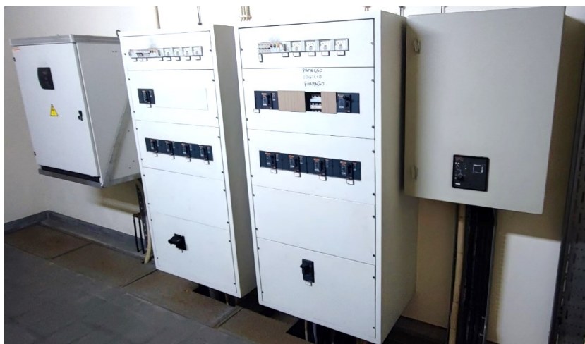
Figura 2.20 - Da esquerda para a direita: bateria de condensadores, QGBT (“emergência”), QGBT (“normal”) e automatismo de comutação automática instalados no edifício
