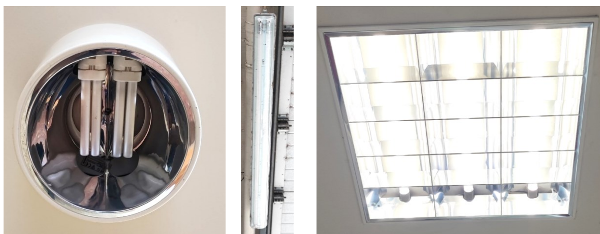
Figura 2.24 - Exemplos de luminárias instaladas no interior do edifício
