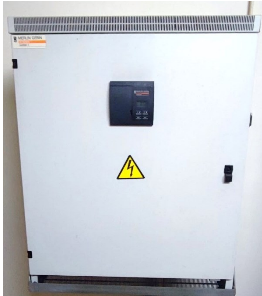
Figura 2.21 - Bateria de condensadores instalada no edifício
