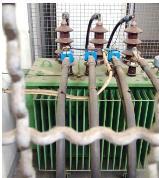
Figura 2.18 - Transformador de distribuição instalado no edifício
