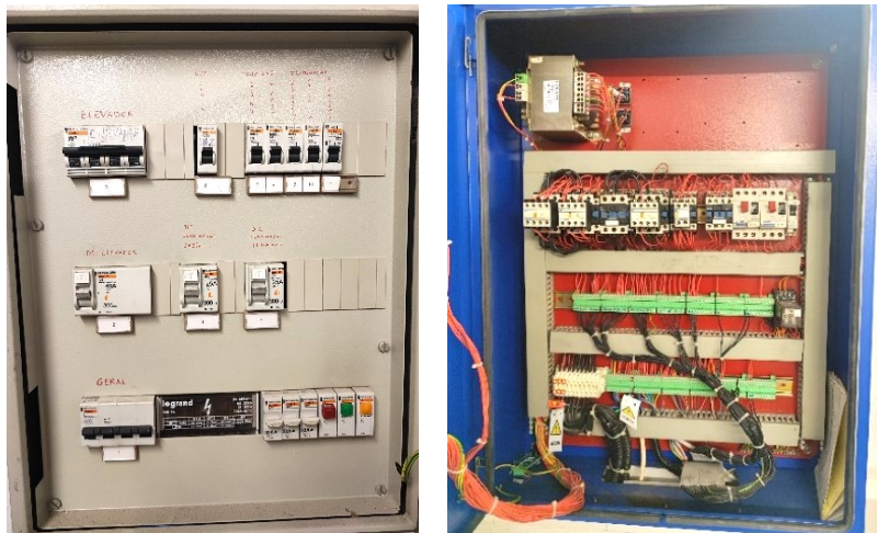
Figura 2.16 - Da esquerda para a direita: quadro de proteção e de comando instalados na “casa das máquinas” do edifício
