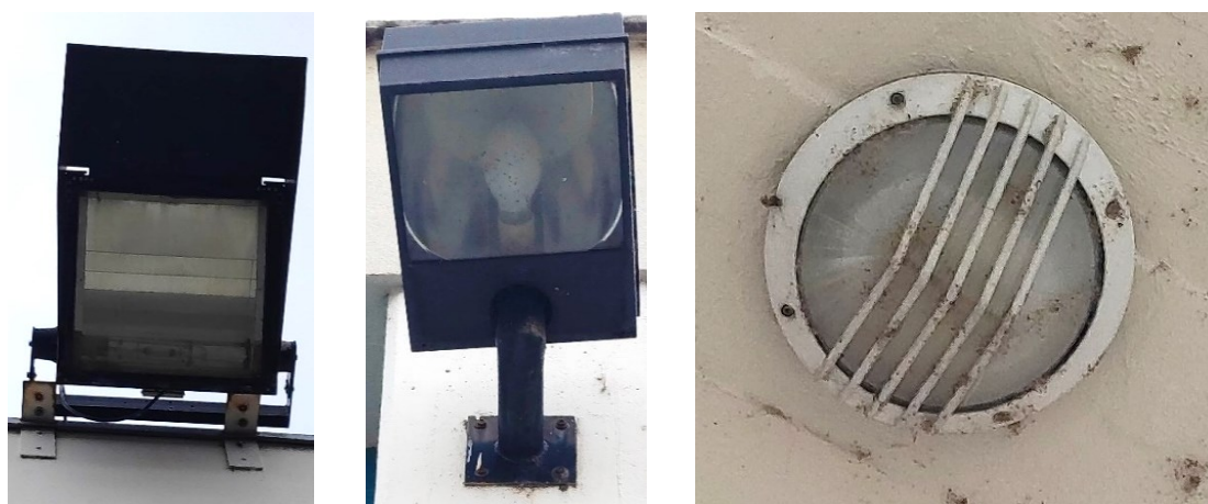
Figura 2.25 - Exemplos de luminárias instaladas no exterior do edifício
