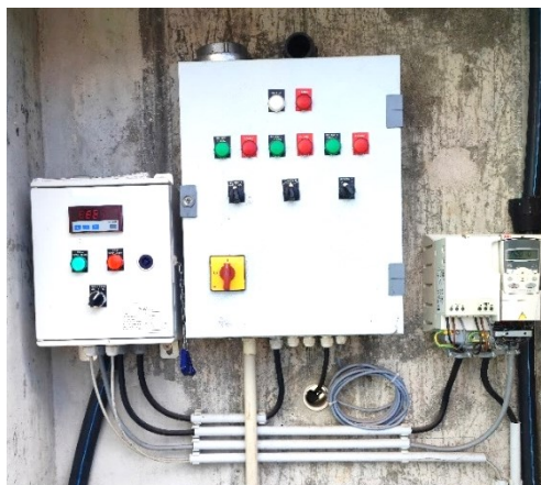
Figura 2.30 - Quadro de bombagem (proteção e comando) instalado no edifício
