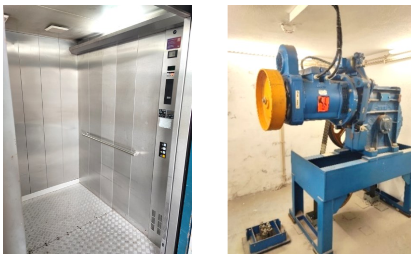
Figura 2.15 - Cabine de elevador e motor elétrico instalados no edifício
