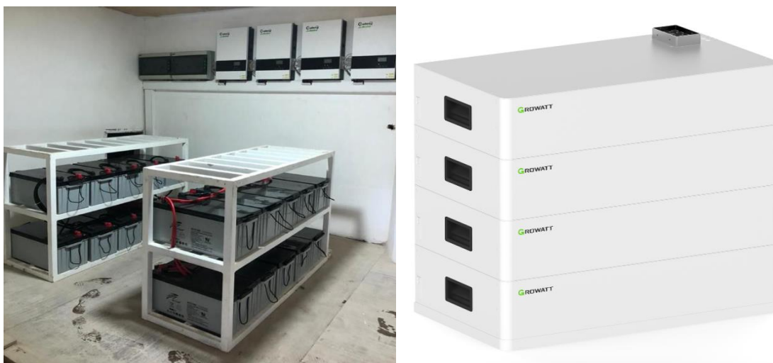
Figura 3.20- Vários tipos de racks de baterias (PV Magazine, 2022).
