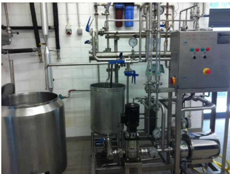
Figura 1 – Instalação piloto do UF da ESAC.
