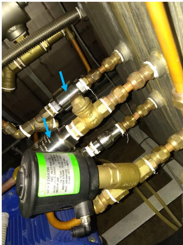
Figura 20 - Purgadores de Vapor
