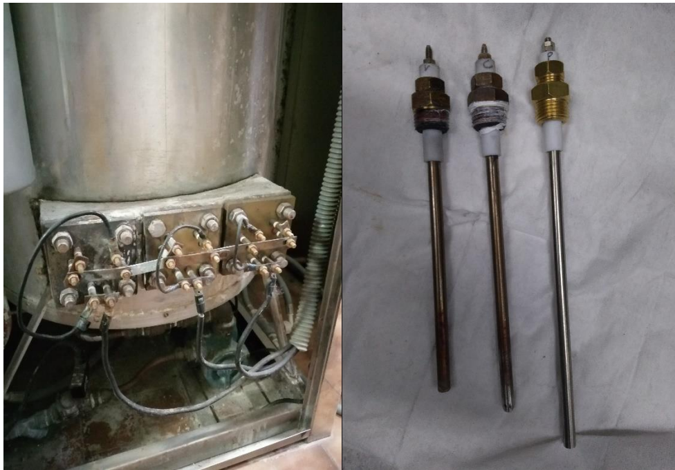
Figura 21 - Gerador de Vapor (esquerda); Sonda de Nível (direita)
