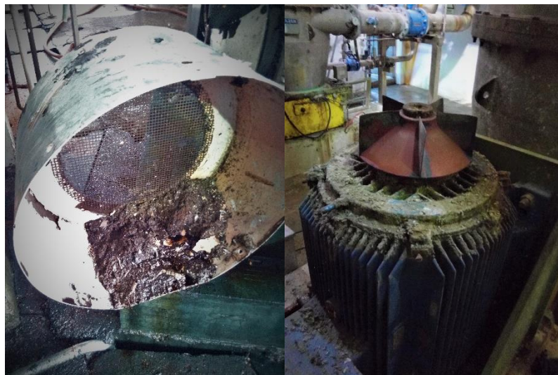
Figura 5-14 – Acumulação de resíduos a obstruir a ventilação.
