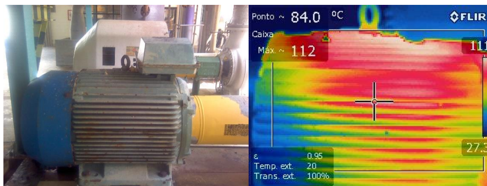
Figura 5-20 – Termografia da parte superior da carcaça do motor.
