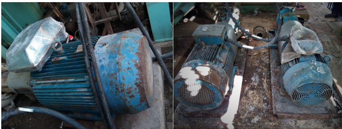
Figura 5-13 – Motores em ambientes corrosivos.
