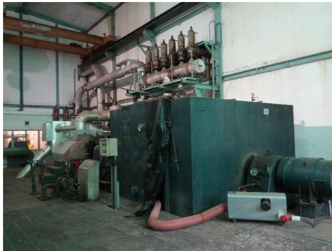
Figura 5-38 – Vista da instalação da TG3 – Alternador e excitatriz à direita.
