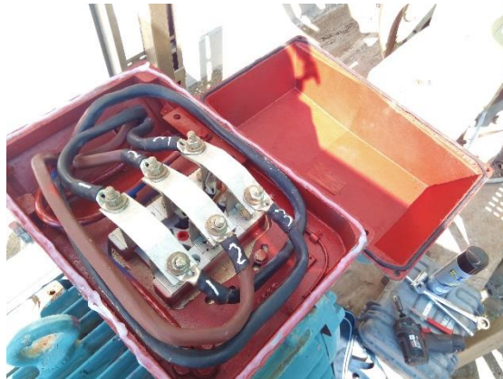
Figura 5-12 – Caixa de ligações de um motor intervencionado.
