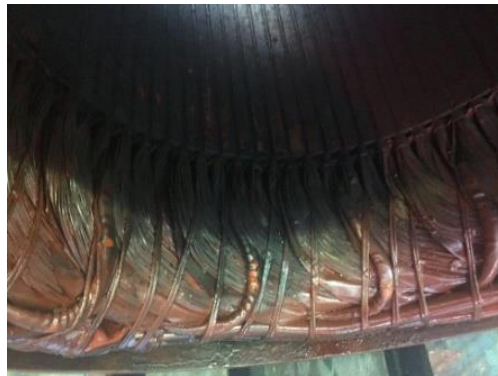
Figura 5-19 – Isolamento queimado no lado do ataque.
