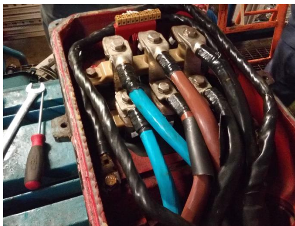
Figura 5-6 – Caixa de Ligações do Motor de Ar Secundário da CR4.
