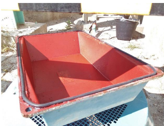
Figura 5-11 – Tampa da caixa de ligações de motor intervencionado.
