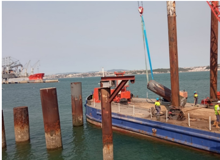
Figura 23 - Estacas danificadas e 1º troço cortado
