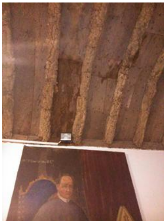
Figura 3. 7 – Exemplo das infiltrações no teto do Convento de Santa Cruz.
