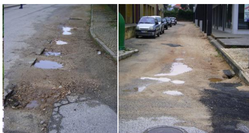
Figura 46 – Mau estado de conservação dos pavimentos
