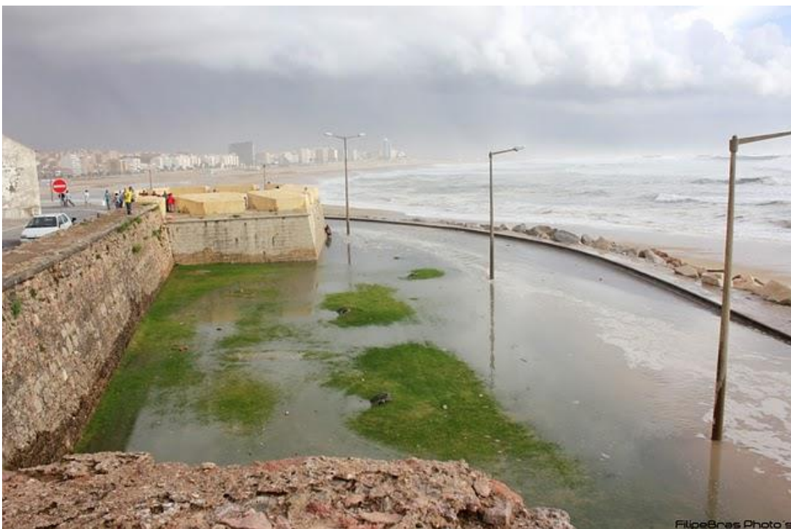
Figura 63: Imagem do efeito de galgamentos a norte do Forte de Buarcos. Fonte: Fotografia de Filipe Brás, tirada a 9 de outubro de 2010
