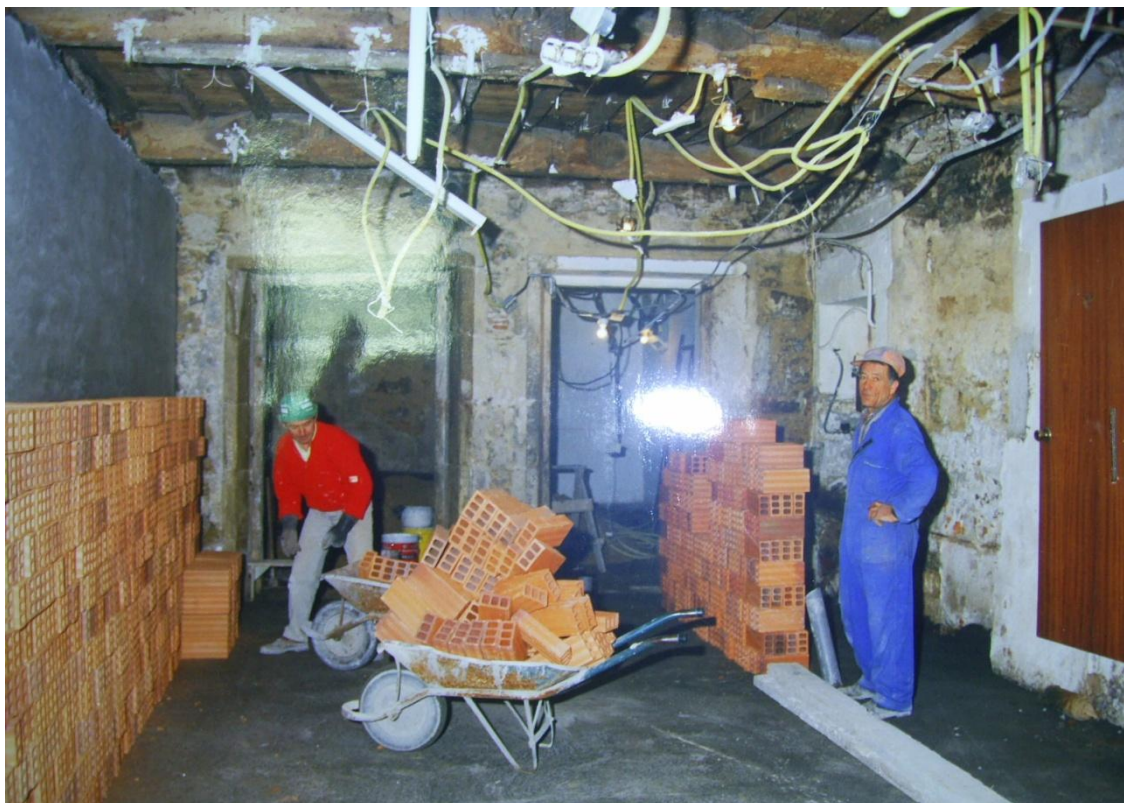
Fig. 211: Estado del local de la antigua fábrica de hielo antes de su última rehabilitación, 1992 (FUENTE: Proyecto de Ejecución, AGC).
