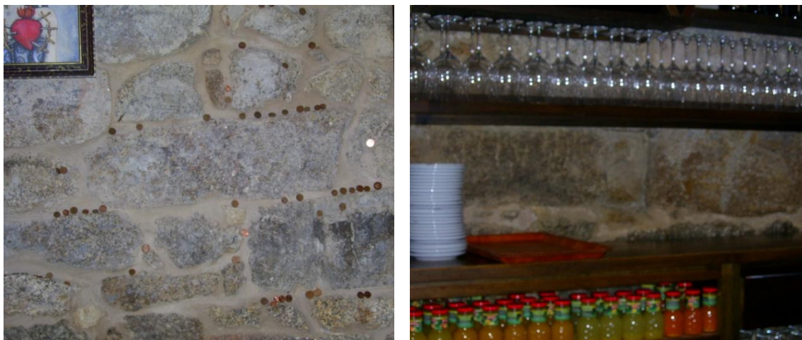
Fig. 242-243: Vista de los muros originales del interior de la antigua fábrica de caramelos.
