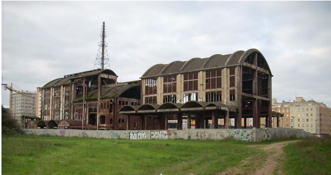
Fig. 44: Estado de la fábrica de Cros de Culleredo antes de su intervención.
