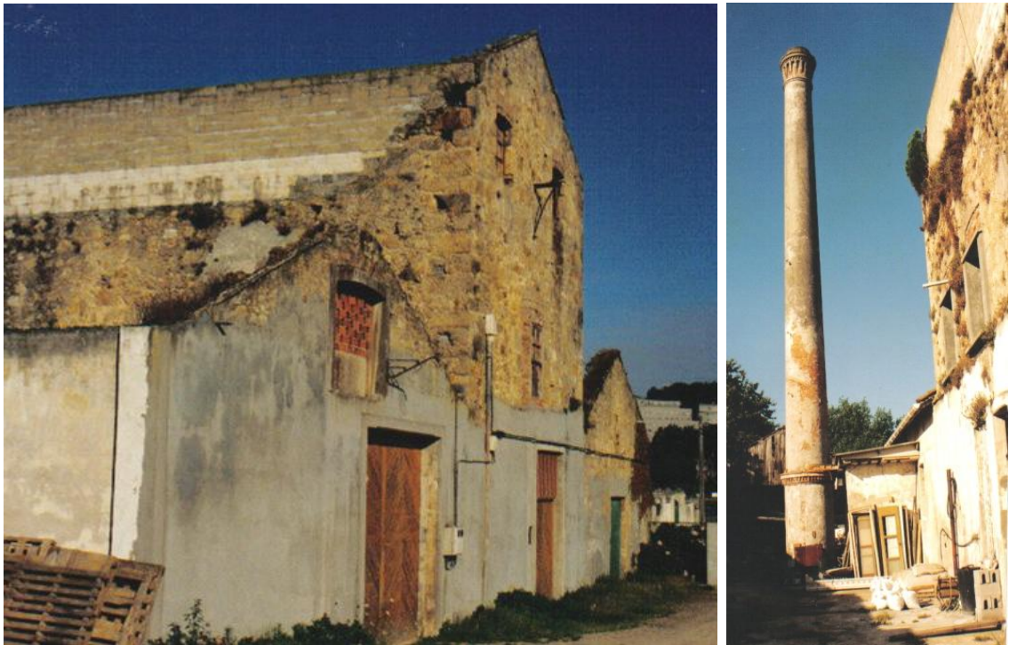
Fig. 48: Estado ruinoso de la fábrica de Perillo, antes de su rehabilitación (FUENTE: Estudio de Arq. NAOS, Coruña).
