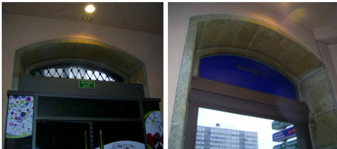
Fig. 295-296: Vista de la estructura de los vanos originales de la antigua fábrica de chocolate.
