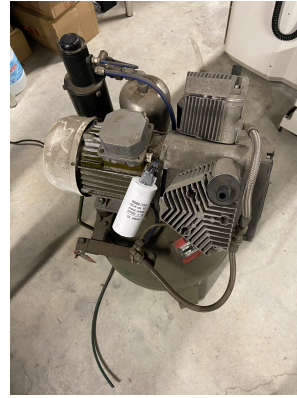
Figura 3.28: Compressor de ar.
