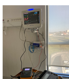
(d) Teste de segurança elétrica
