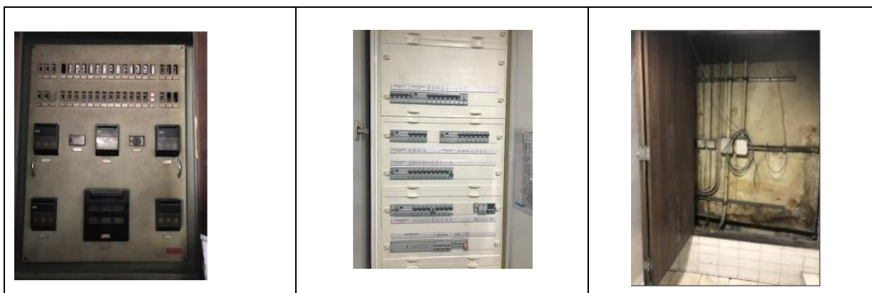
Figura 23 – Quadros elétricos e cabos (autor)
