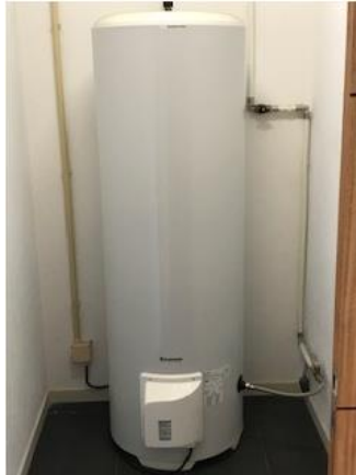
Figura 29- Termoacumulador AQS (autor)
