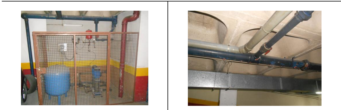
Figura 20- Central hidropneumática e Rede de águas (autor)
