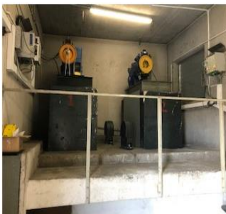
Figura 26- Elevadores- Casa das máquinas (autor)
