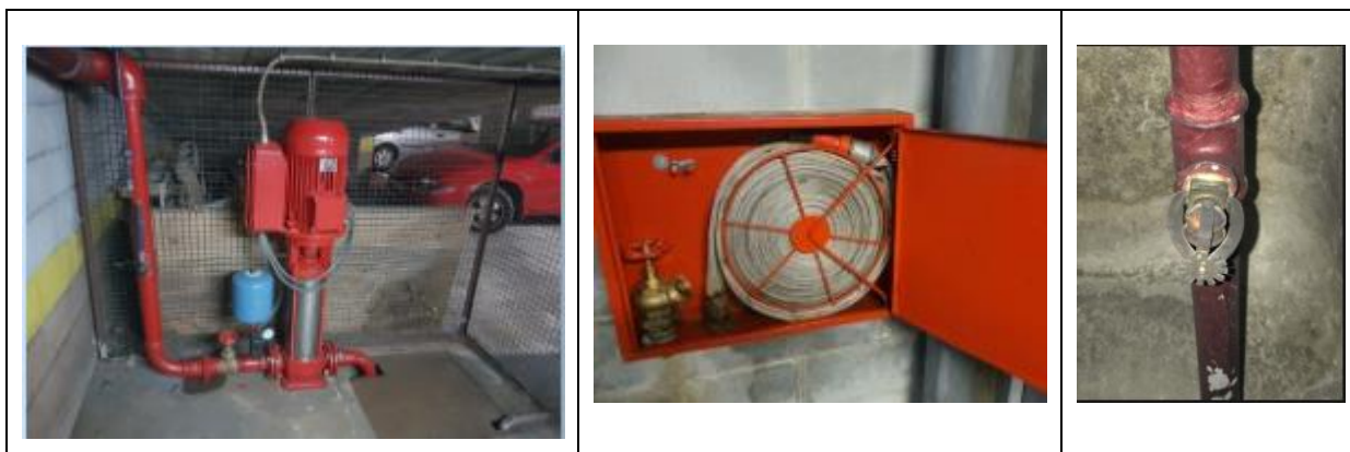
Figura 24 – Sistema de bombagem e RIA (autor)
