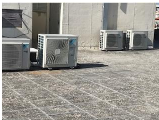
Figura 28- Equipamento de ar condicionado (autor)
