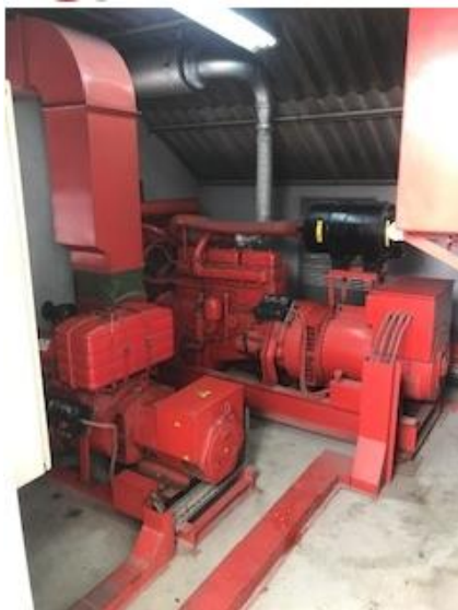
Figura 27- Grupos geradores eletrogêneos (autor)
