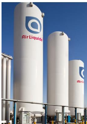
Telma Figura 2- tanques criogénicos
