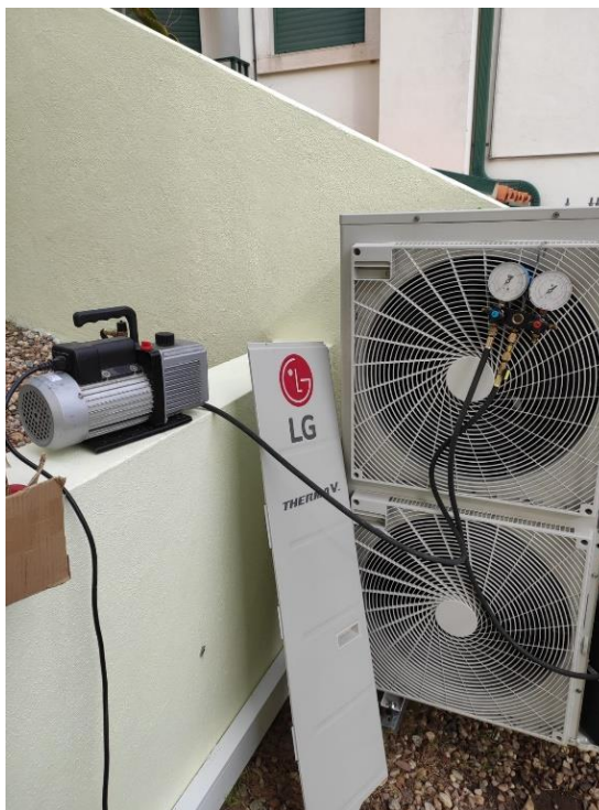
Figura 40: Acessórios para despressurização da tubagem.
