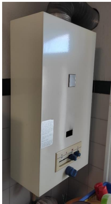
Figura 14: Equipamento produtor de calor.
