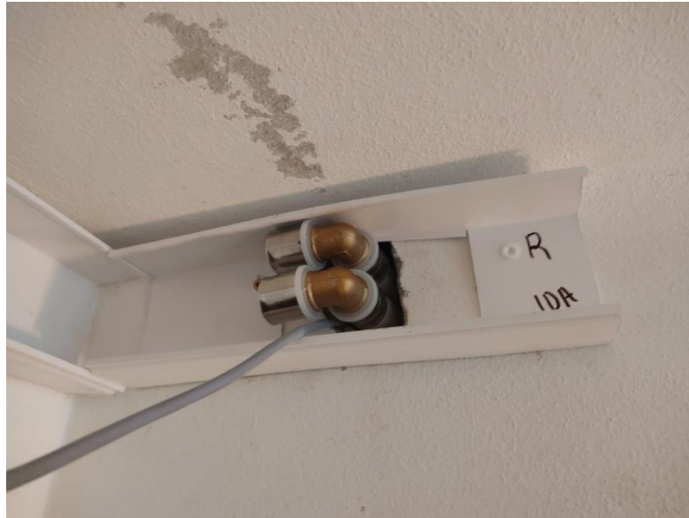
Figura 27: Calha técnica para passagem de tubagem.
