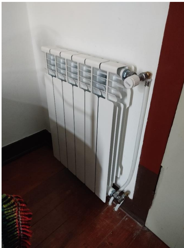
Figura 28: Aspeto final da instalação do radiador.
