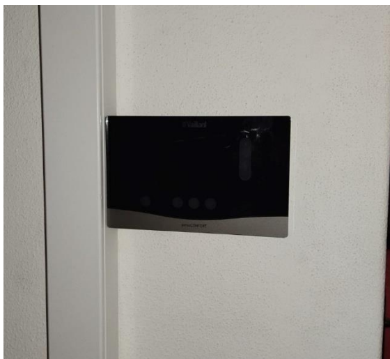
Figura 29: Controlador da bomba de calor.
