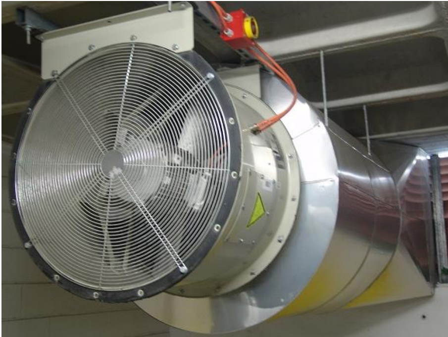
Figura 30 - Ventilador de estacionamento.
