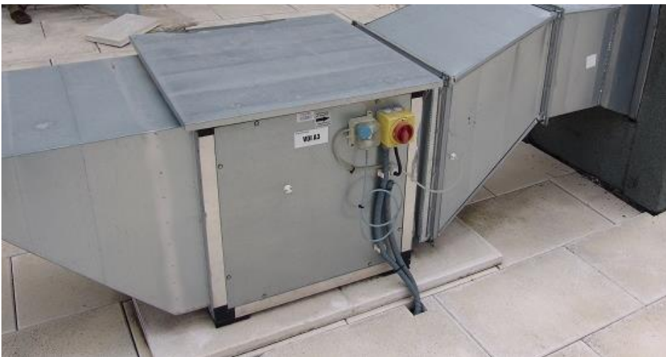
Figura 29 - Ventilador de extração.
