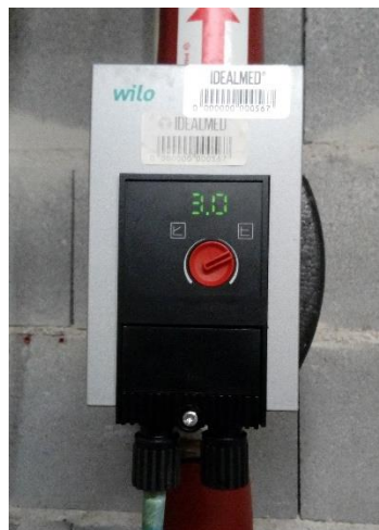
Figura 11 - Bomba circuladora do circuito de painéis solares.
