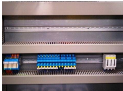
Figura 3.23 – Quadro elétrico auxiliar.
