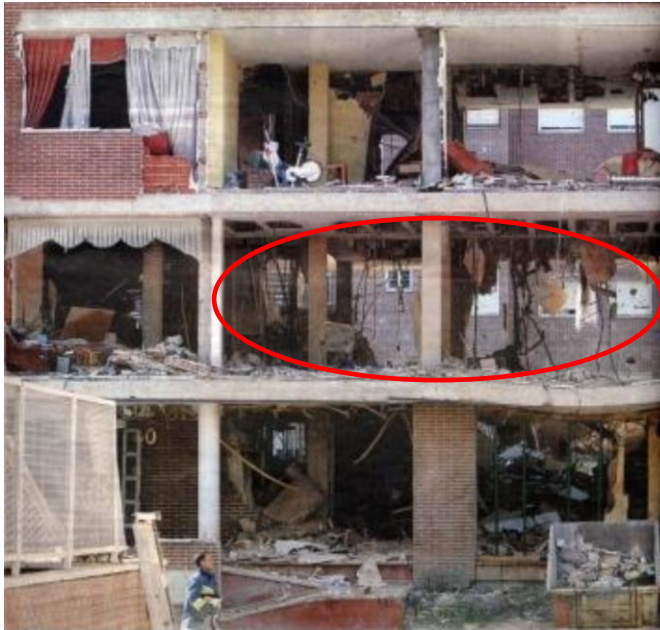
Fig. 1 – Local de detonação e estado do(s) apartamento(s) após a detonação dos terroristas.
