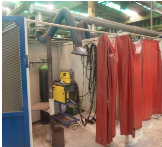
Figura 5 : Cabines de Soldadura
