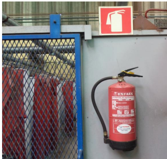
Figura 9 : Exemplo de extintor junto às cabines de soldadura
