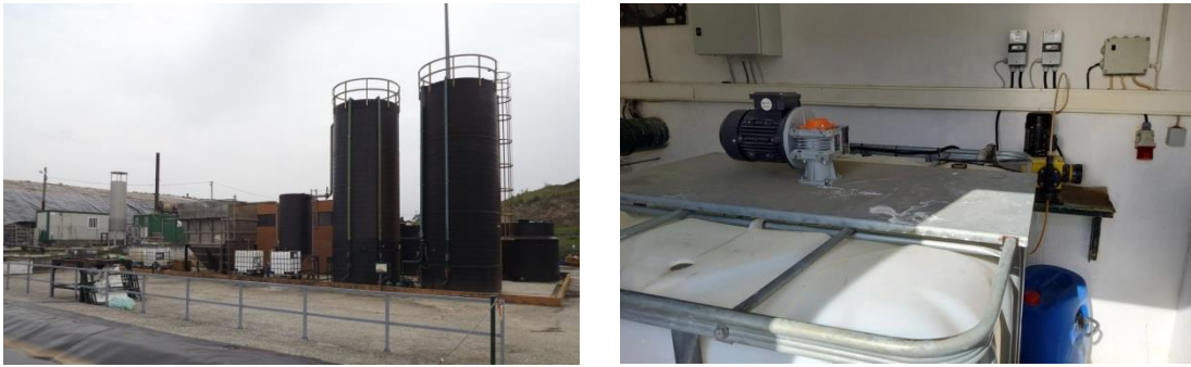
Figura 42 - Esq.: zona de oxidação química, Dir.: cuba de ácido fosfórico, agitador e bomba doseadora.
