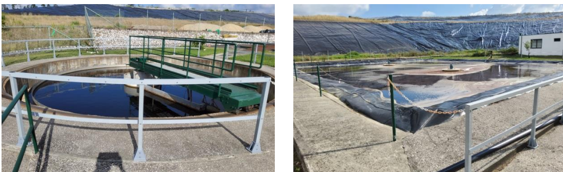
Figura 41 - Esq.: decantador secundário, Dir.: agitadores.
