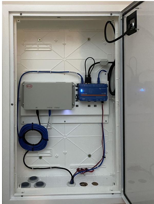
Figura 4.8: Instalação dos equipamentos de controlo e monitorização
