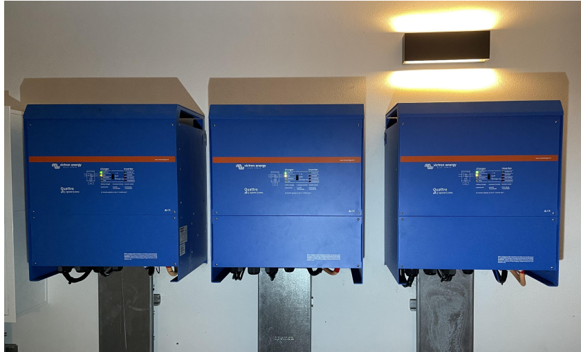
Figura 4.3: Instalação dos 3 inversores/carregadores Victron Quattro
