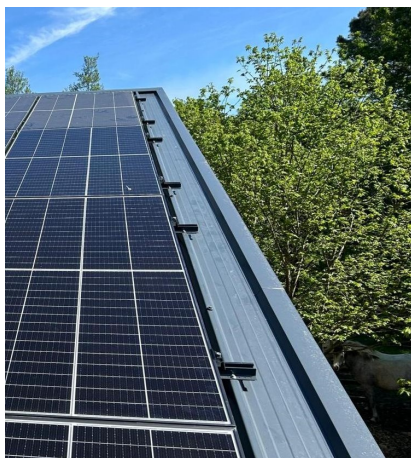
(a) Estrutura mini rail
