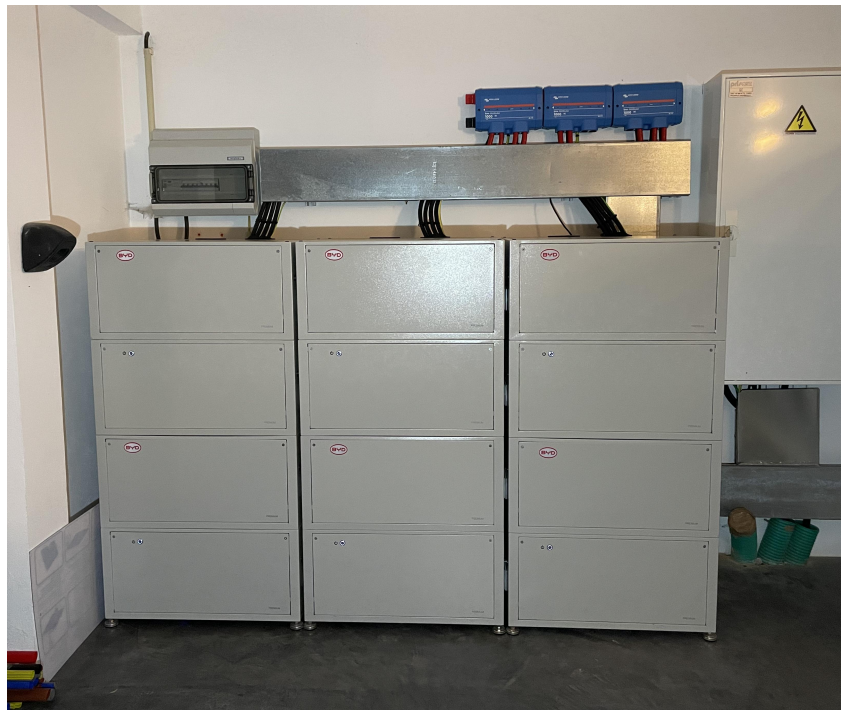
Figura 4.6: 6 racks de Baterias instaladas
