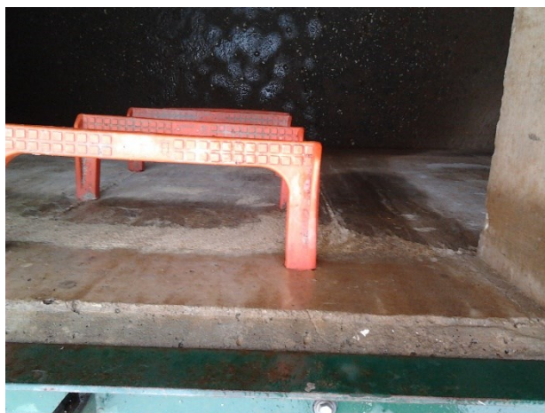
Foto 10 – Caixa de acesso a injeção de cloro (Fonte: produção própria)
