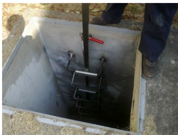
Foto 17 – Dispositivo instalado no primeiro acesso (Fonte: produção própria)
