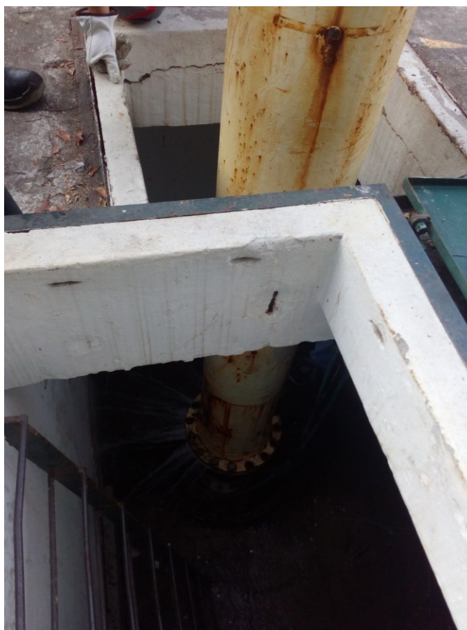
Foto 6 – Caixa de acesso a furo de captação (Fonte: produção própria)
