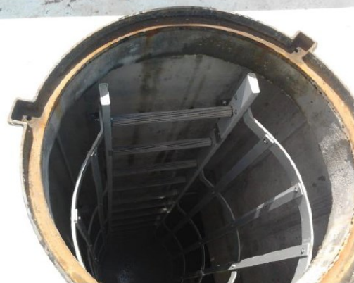
Foto 4 Caixa de conduta de água
