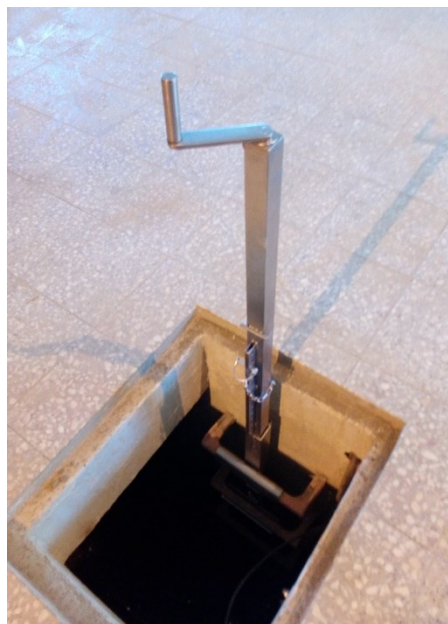
Foto 20 – Dispositivo final instalado no acesso a tanque de lamas (Fonte: produção própria)
