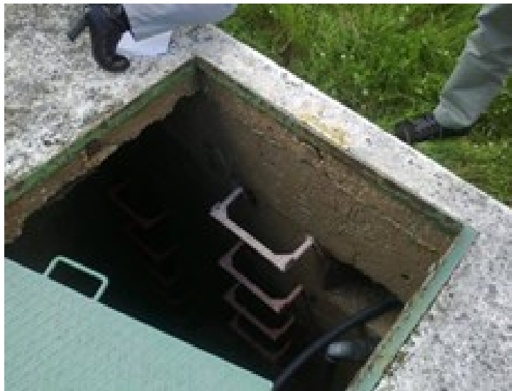
Foto 1 - Caixa para injeção de cloro em conduta
