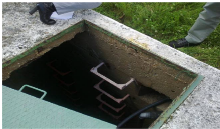
Figura 1 – Caixa para injeção de cloro em conduta
