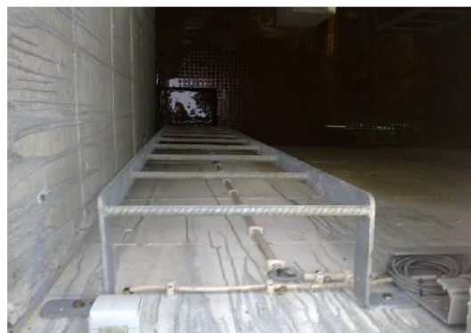
Foto 2 Caixa com medição de caudal em conduta
