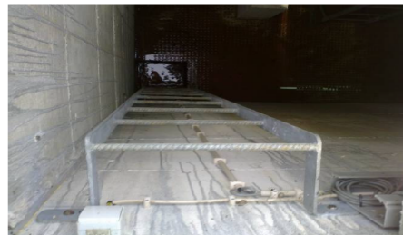
Figura 2 – Caixa com medição de caudal em conduta
