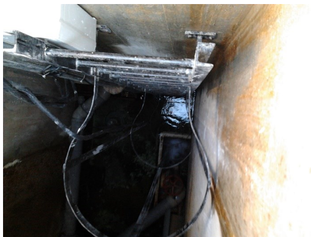
Foto 11 – Caixa de acesso a medidor de caudal (Fonte: produção própria)
