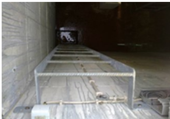
Foto 1 – Caixa com medição de caudal em conduta
