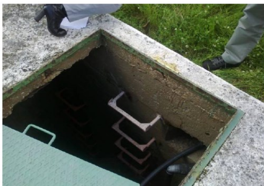
Foto 1 Caixa para injeção de cloro em conduta
