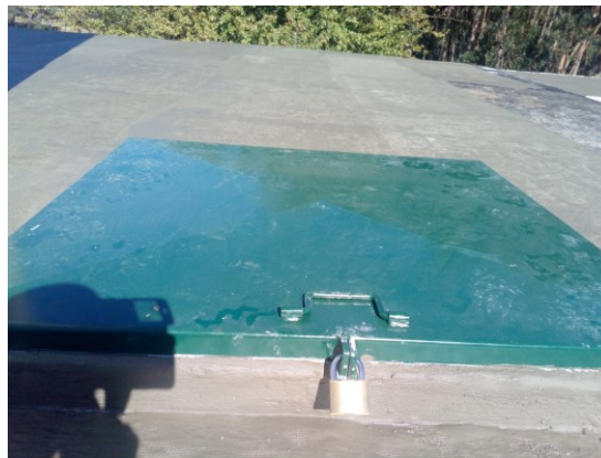
Foto 8 – Abertura de acesso à câmara de aspiração de Estação Elevatória (Fonte: produção própria)
