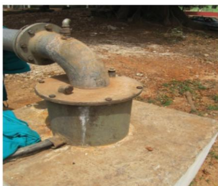
1-Imagem da Captação do sistema de HNSM
