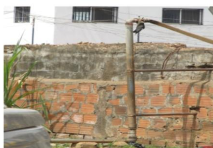
4- Sistema de Boca de incêndio
