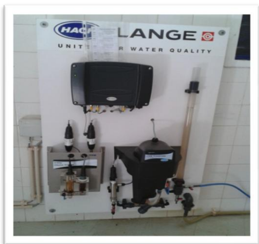
Sistema Controlo de Qualidade da água
