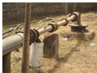
2-Imagem da Adutora do Sistema Alto Crim
