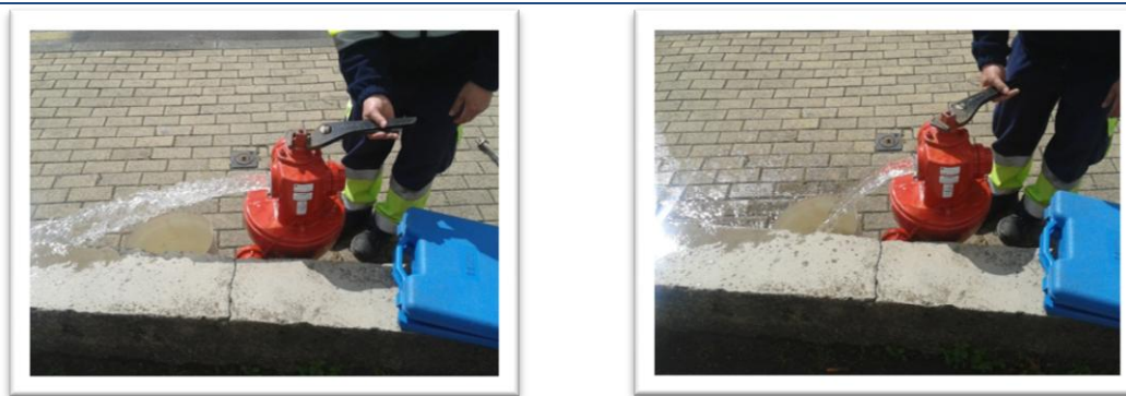
Figura 7: Descarga de águas numa boca-de-incêndio
