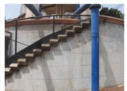
3- Imagem do reservatório da EE
