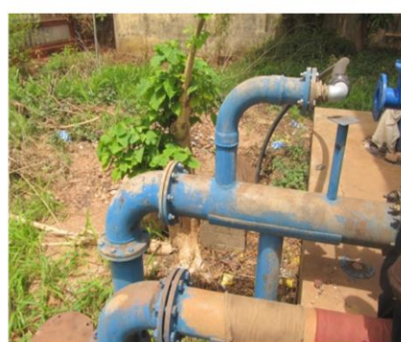
2-Imagem das condutas de distribuição
