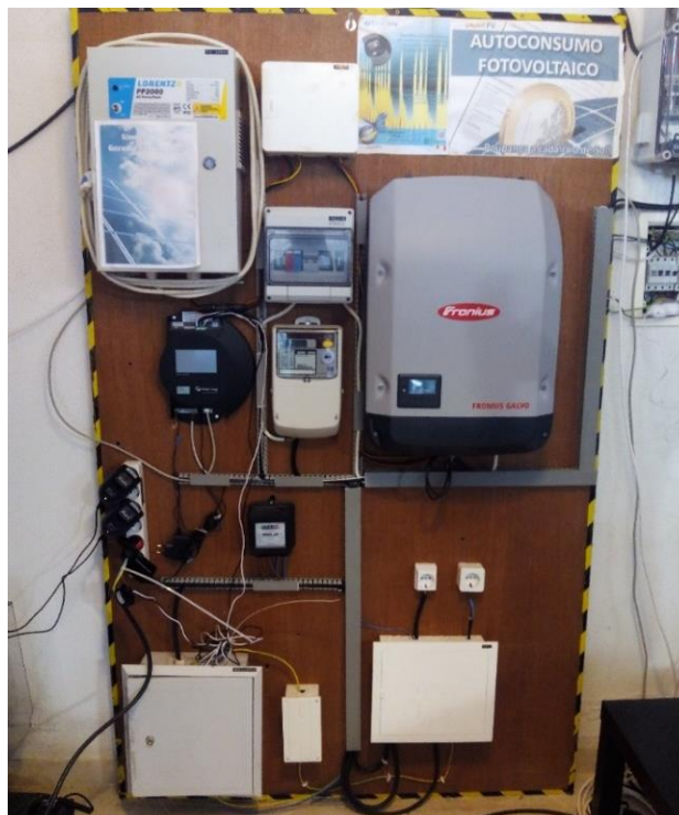
Figura 46 - Instalação de autoconsumo com sistema de monitorização Solar-Log
