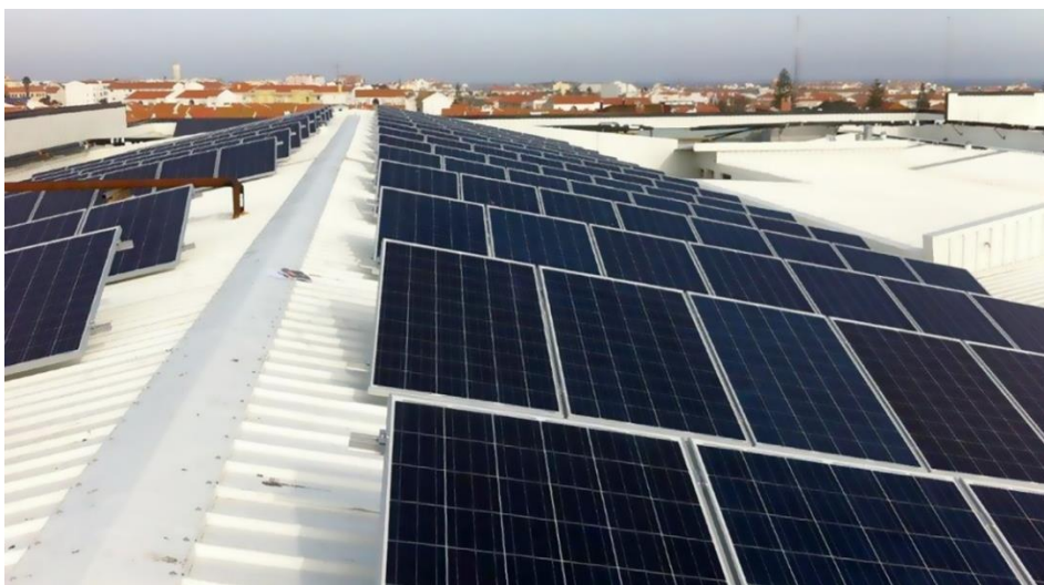
Figura 49 - Instalação Fotovoltaica a ser monitorizada [35]
