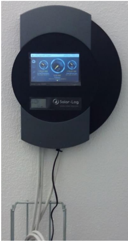
Figura 50 - Instalação Solar-Log 2000 com controlo de injeção
