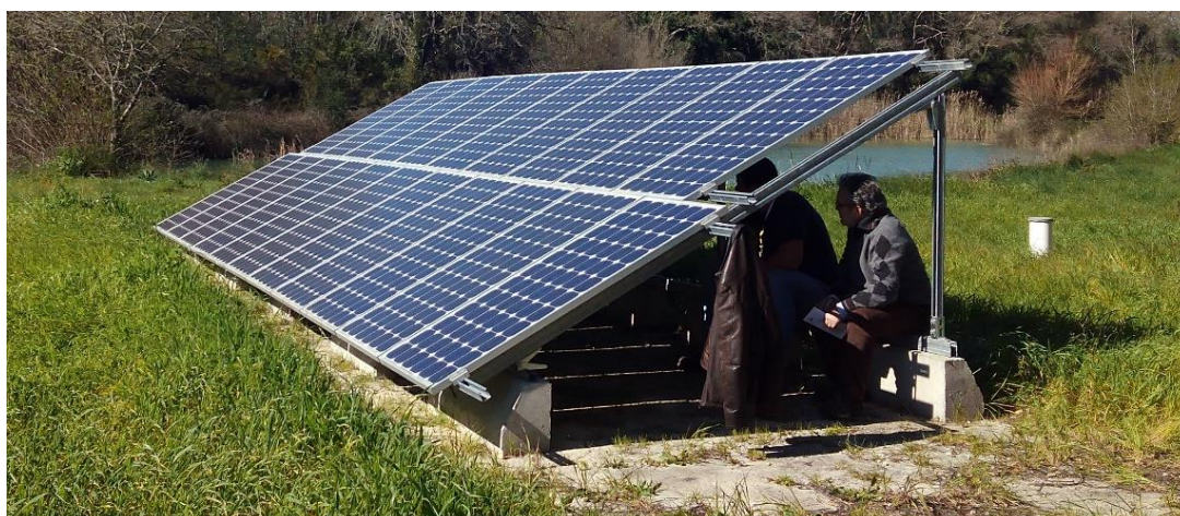
Figura 47 - Unidade de Pequena Produção de 3,675kWp
