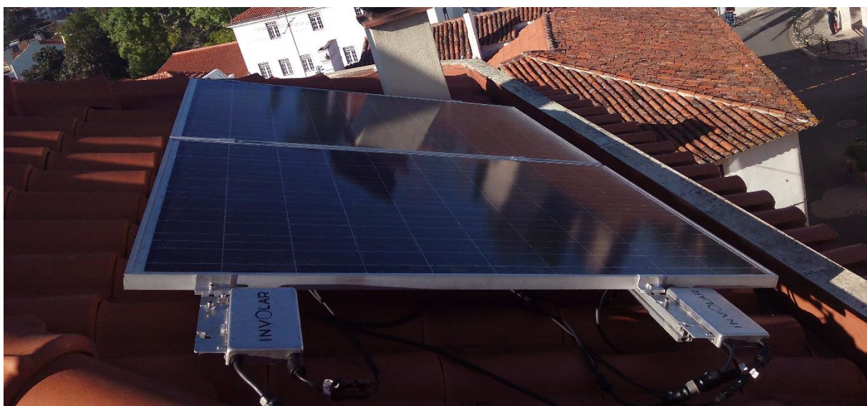
Figura 32 - Instalação utilizando microinversores instalada nas instalações da CRITICAL KINETICS
