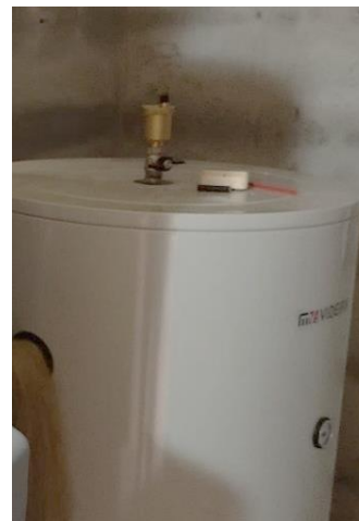
Figura 54 - Purgador de ar automático no topo do acumulador de inércia
