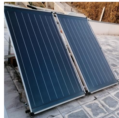
Figura 33 - Coletores solares térmicos instalados
