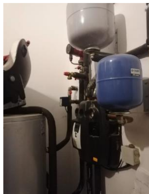
Figura 32 - Tubagens e componentes existentes
