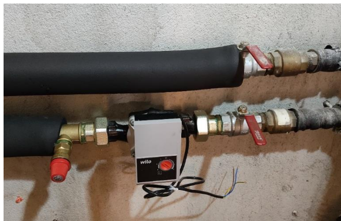
Figura 52 - Bomba de circulação do fluido térmico
