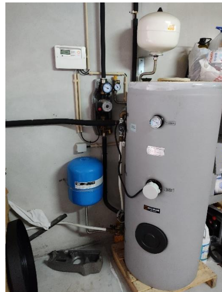
Figura 12 - Termoacumulador e restantes componentes
