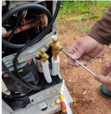
Figura 60 - Abertura de válvula de corte para libertação do fluido
