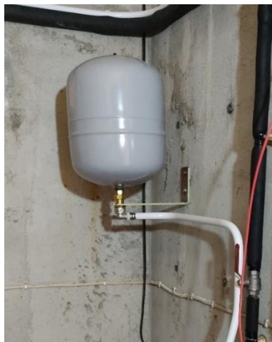
Figura 53 - Vaso de expansão de aquecimento
