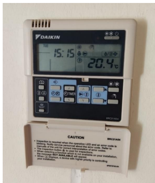
Figura 61 - Controlador da bomba de calor
