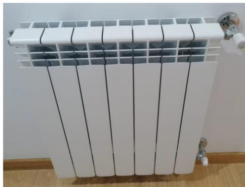
Figura 31 - Fotografia dos radiadores instalados
