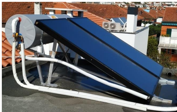
Figura 10 - Sistema solar térmico termossifão
