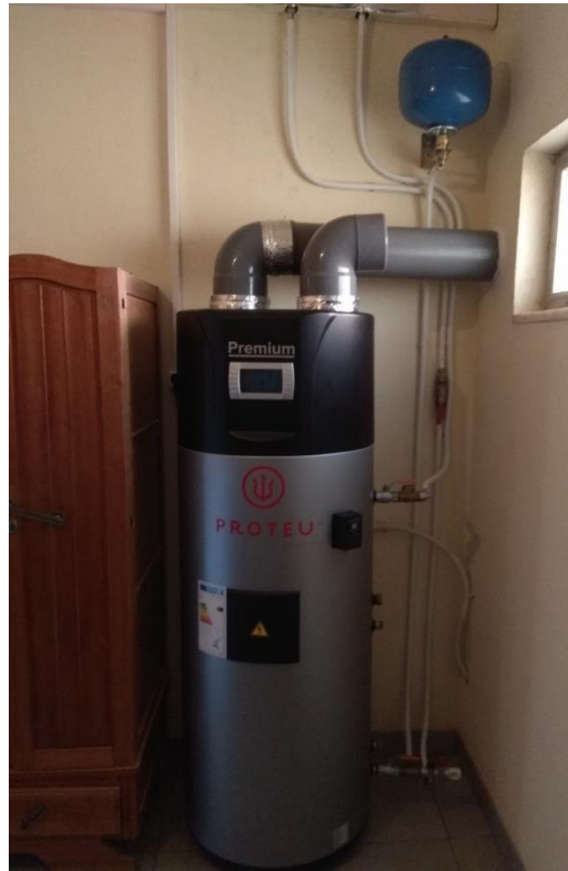
Figura 62 - Bomba de calor de AQS instalada
