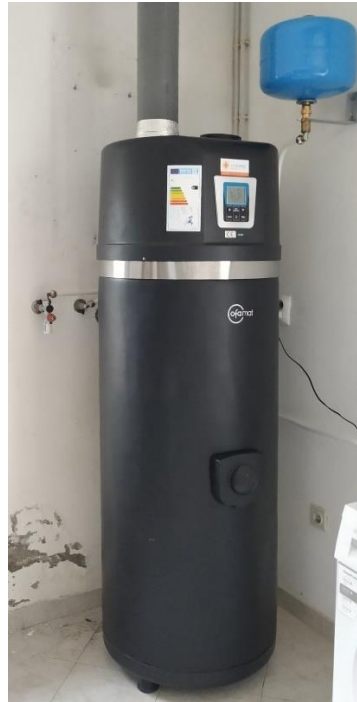
Figura 6 - Bomba de calor de AQS
