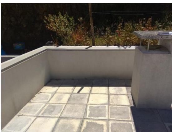
Figura 45 - Local definido para a instalação da bomba de calor
