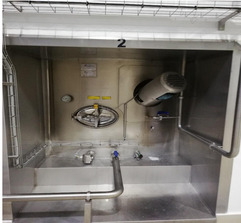
Figura 12: Pormenor do tanque pulmão
