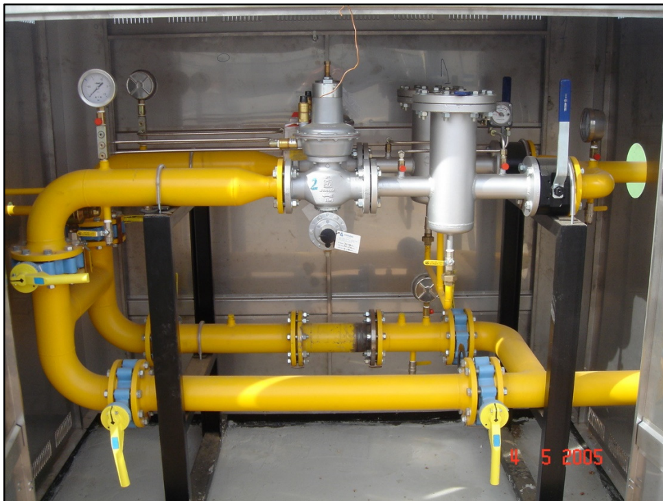
Figura 1 – Vista geral de um Posto de Regulação e Medida (PRM)
