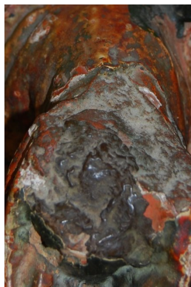
Fig. 44 Intervenções anteriores AT - Preenchimento da lacuna.
