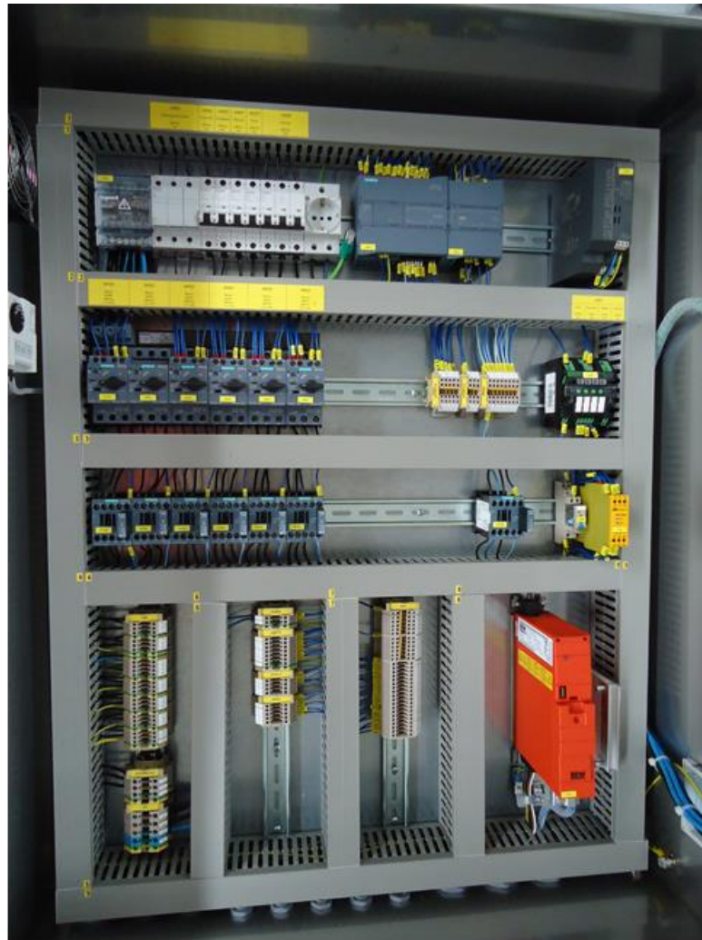
Figura 26-Quadro elétrico do virador de bidões.
