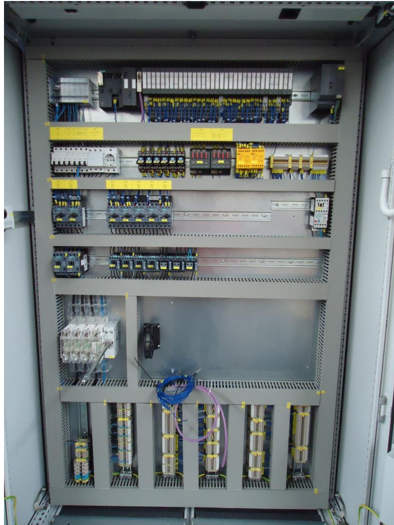
Figura 42- Platine do quadro elétrico do despaletizador de sólidos.
