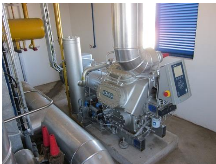
Figura 2 – Compressor 1 com controlador Unisab 3.
