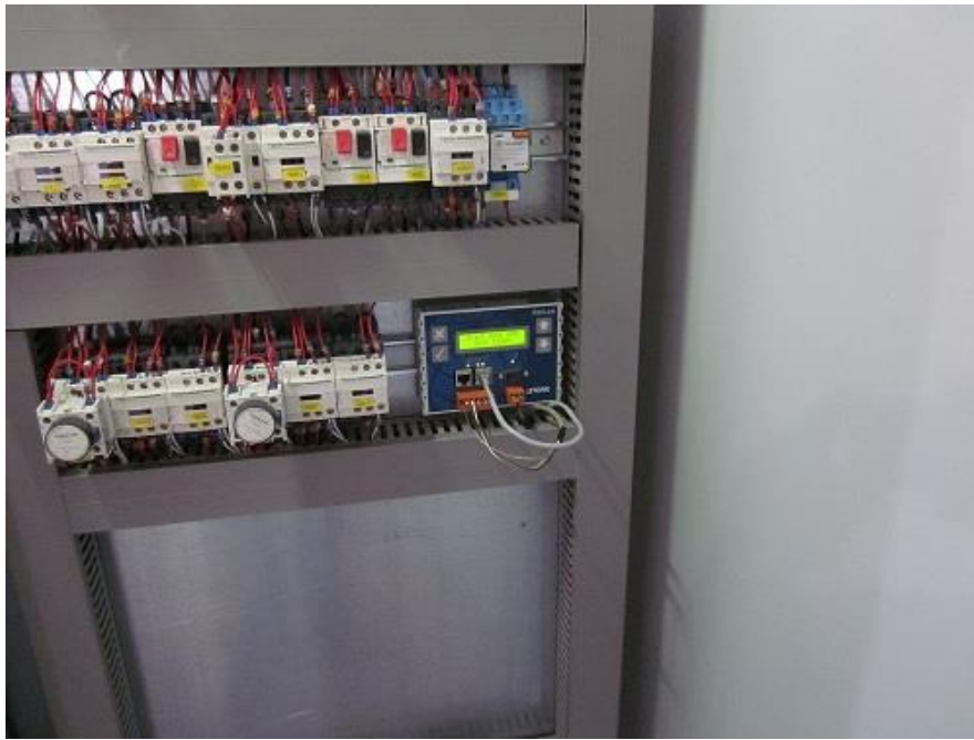
Figura 4 – Localização do switch no quadro elétrico.
