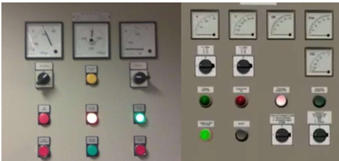
Figura 30 - Quadro controlo local gerador
