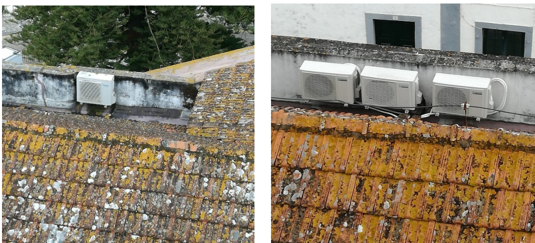
Fig. 49 - Algumas unidades exteriores dos sistemas de ar condicionado (Fotos do autor, junho 2018)
