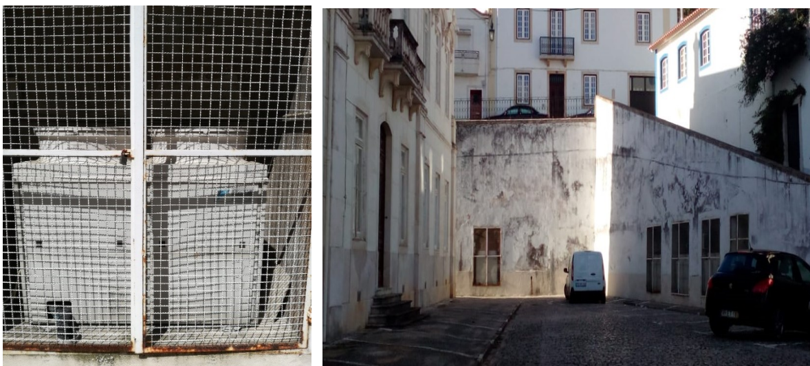
Fig. 48 - Equipamento “VRV INVERTER” (à esquerda) e localização dos equipamentos (à direita) (Fotos do autor, junho 2018)
