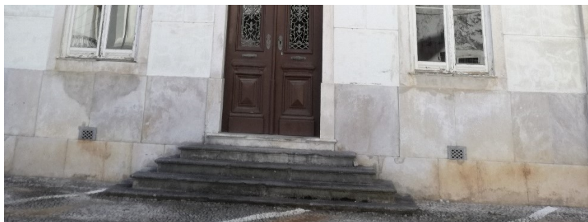
Fig. 38 - Diferença de cota entre o passeio e o pavimento do edifício e duas das grelhas de ventilação existentes na fachada tardoz (Foto do autor, junho 2018)
