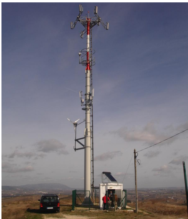
Figura nº10 - Antena de comunicação da VODAFONE.
