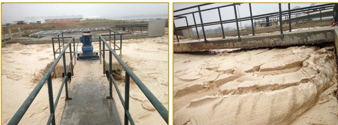
Figura 5: Exemplo do aspeto das espumas que se formam em tanques biológicos em ETAR de lamas ativadas e arejamento prolongado, na zona sul do concelho da Figueira da Foz, recetora de efluentes industriais provenientes do Porto de Pesca.
