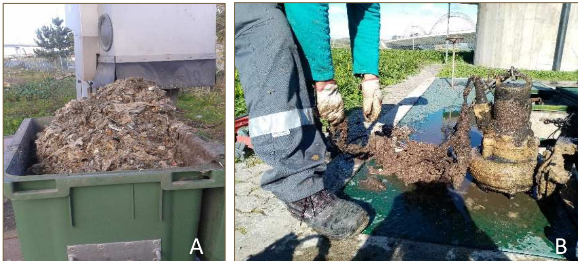
Figura 2: A - Resíduos retirados por um tamisador e compactador de um coletor doméstico à chegada da EEAR de Salmanha (Figueira da Foz). Esta EEAR encontra-se no fim de linha do sistema de drenagem urbano, antes da ETAR e nos contentores é visível a quantidade de cabelos que atravessam todo o sistema e chegam à ETAR. B- Encravamento provocado fibras, cordas e toalhetes que após drenagem de todo o sistema, chegaram ao poço de recirculação de uma ETAR, provocando a sua avaria, paragem e conseqüente danos no tratamento biológico.
