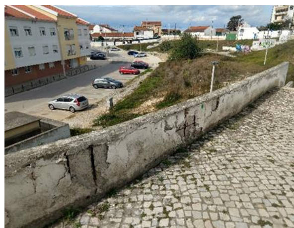
Figura 106: Delaminação do betão de recobrimento
