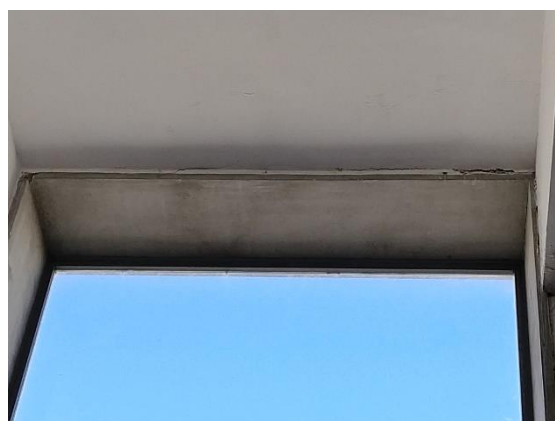
Figura 64: Infiltrações no teto
