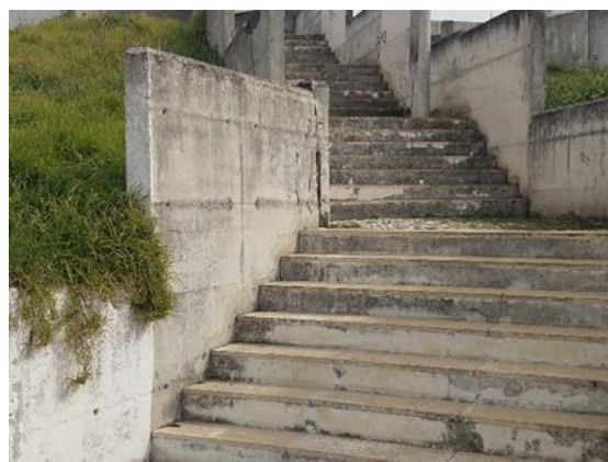
Figura 108: Escadaria com várias corrosões nas armaduras
