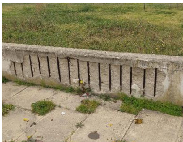
Figura 105: Delaminação do betão de recobrimento no muro
