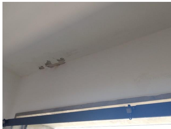
Figura 58: Infiltração no teto de uma das salas do auditório
