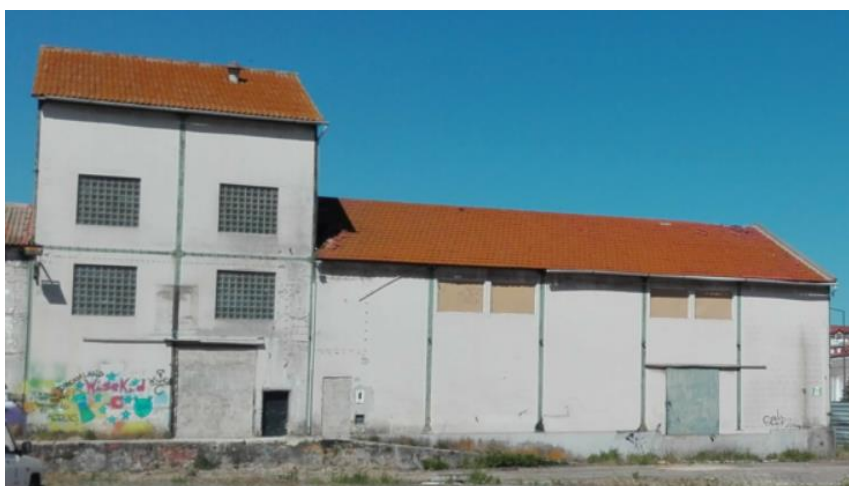
Figura 74: Telhado em telha cerâmica, em estado de degradação - In: Pórtico Gabinete de Engenharia LTDA
