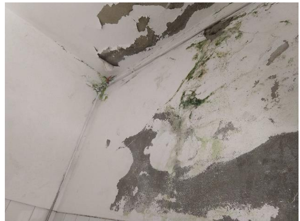
Figura 101: Alto nível de infiltração nas boxes das instalações sanitárias
