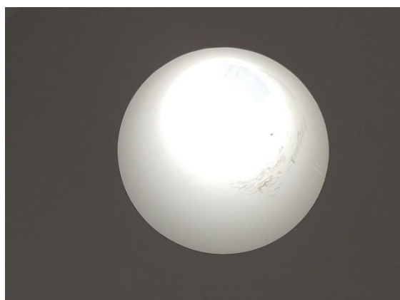
Figura 63: Infiltração nas claraboias visto pelo interior da edificação
