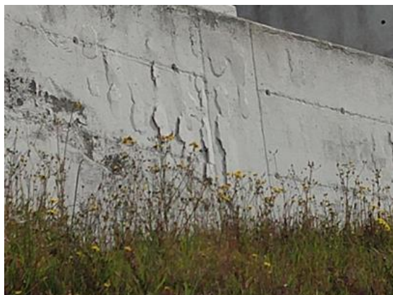
Figura 109: Delaminação do betão de recobrimento com início da exposição das armaduras
