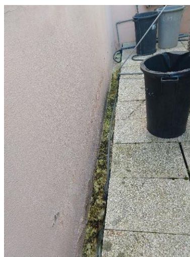
Figura 60: Terraço onde possivelmente origina-se a infiltração
