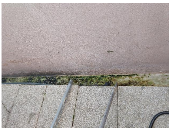
Figura 59: Terraço onde possivelmente origina-se a infiltração
