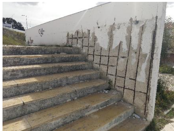
Figura 110: Grande área de exposições das armaduras
