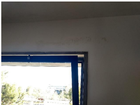
Figura 57: Infiltração que espalhada do teto para parede
