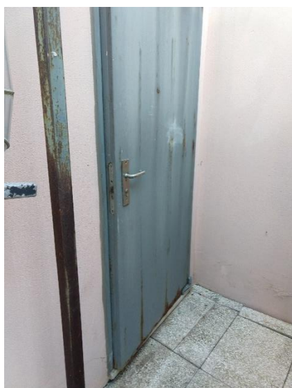
Figura 61: Porta empenada e com ferrugem
