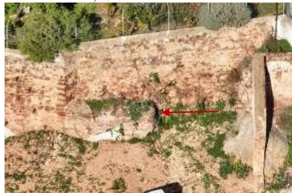
Fotografia do alçado sul do Tramo S1. Desnível de pequeno segmento de muralha devido a fenda estrutural e às movimentações de terra envolvente. Fotografia do arquivo do SCR/CMS, 2023.
