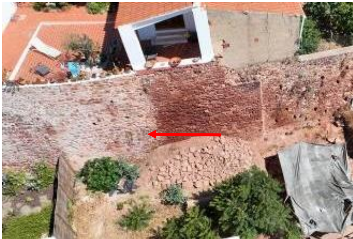
Tramo de muralha S3. Capeamento da muralha original. Alvenaria ordinária com grés de Silves e argamassa à base de cal. Observa-se aplicação descuidada de argamassa branca de intervenção de conservação e restauro realizada em 2022 por empresa privada. Fotografia do arquivo do SCR/CMS, 2024.
