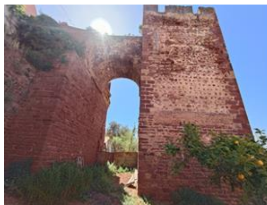
Fotografia do alçado norte da Torre 5. Maior abertura de juntas. EC4 . Fotografia do arquivo do SCR/CMS, 2024.
