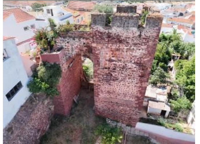
A torre 5 apresenta um revestimento com argamassa de cal sobre o grés de Silves como tentativa de regularização das superfícies. Fotografia do arquivo do SCR/CMS, 2024.
