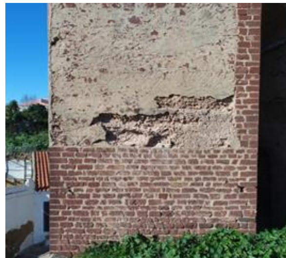
Fotografia do alçado sul da Torre 4 – LEB, 2017. Destacamento do revestimento de taipa.
