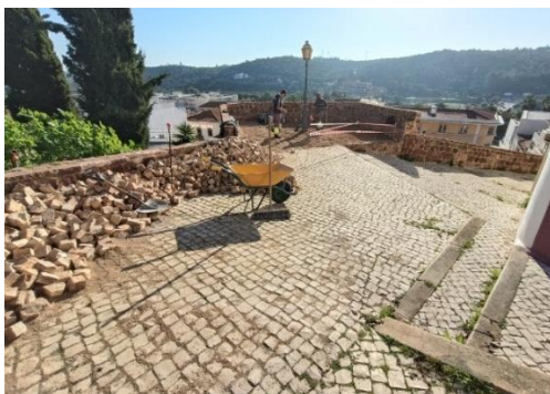
Figura 80: Torre 15 com miradouro na parte superior. Pendente de calçada deficiente devido ao abatimento de terras. Fotografia do arquivo do SCR/CMS, 2024.
