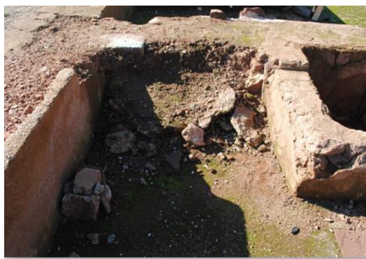
Figura 108: Destacamento do revestimento do suporte. Zona do balneário. Fotografia do arquivo do SCR/CMS, 2021.
