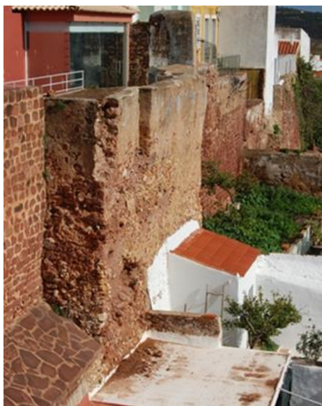
Figura 56: Torre 16 em mau estado de conservação identificado através da monitorização realizada em 2013 (antes da intervenção). Fotografia do arquivo do SCR/CMS, 2014.
