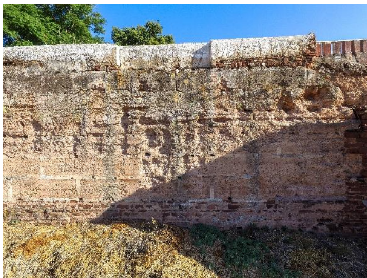
Figura 4: Juntas fingidas de tramo de muralha. Fotografia do arquivo do SCR/CMS, 2017.
