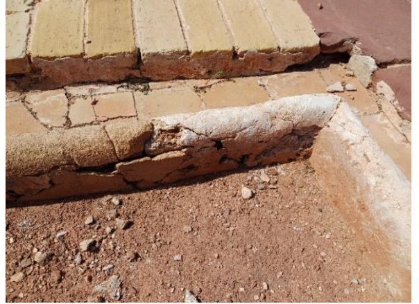
Rebordo original com argamassa fina em meia cana do lado direito e argamassa com cal e areia grossa de intervenção do lado esquerdo. Fotografia: autor, 2025.
