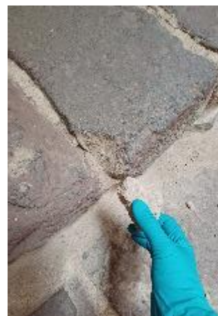
Destacamento de argamassa de preenchimento de intervenção anterior nos degraus de acesso ao interior. Fotografia do arquivo do SCR/CMS, 2024.
