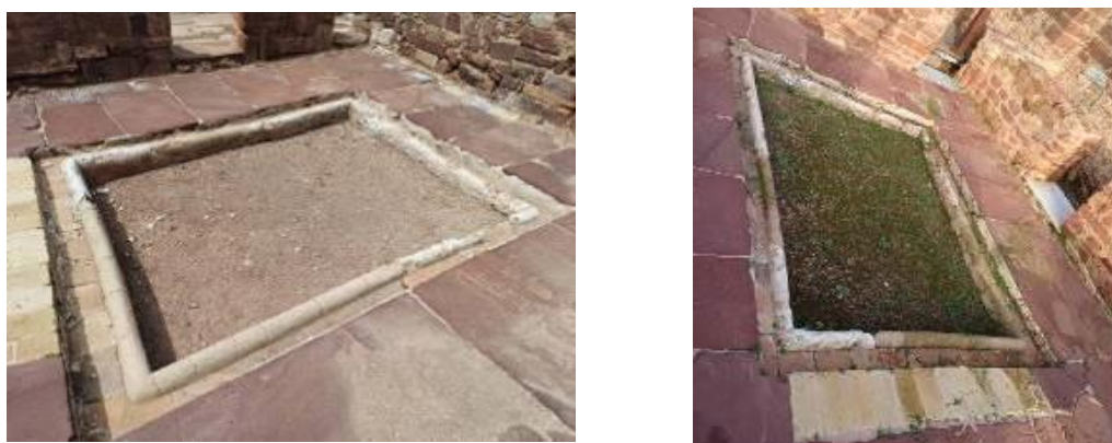
Vista geral do estado de conservação do Jardim onde se verifica o aumento da colonização biológica. Fotografias do arquivo do SCR/CMS, 2023 à esquerda e 2024 à direita.
