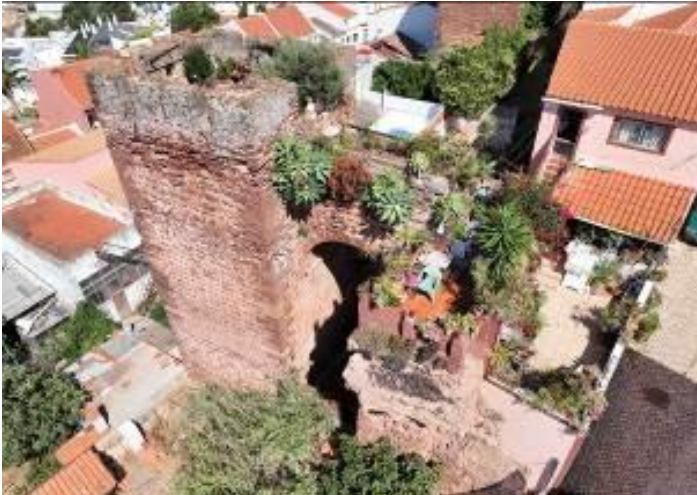
Torre 5 do tipo albarrã construída com alvenaria aparelhada e ordinária com grés de Silves e argamassa de cal. Esta torre está a ser abusivamente utilizada. Fotografia do arquivo do SCR/CMS, 2024.
