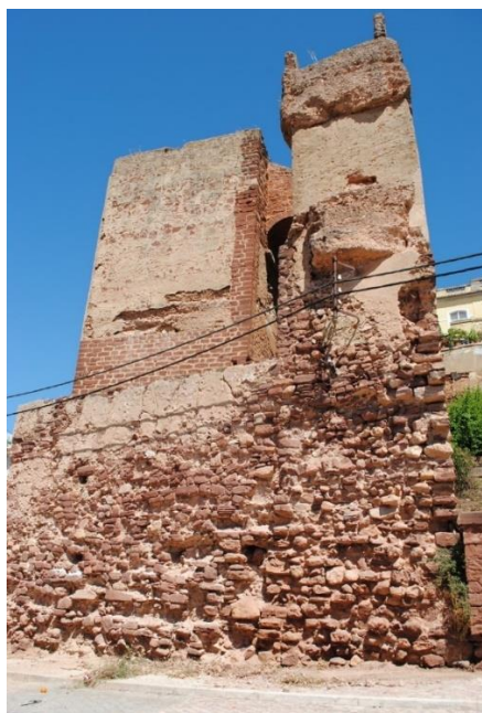
Figura 62: Vista geral do estado de conservação antes da intervenção do Município de Silves. Fotografia do arquivo do SCR/CMS, 2019.
