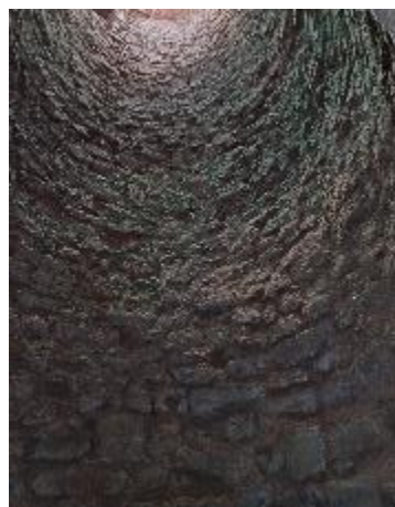
Destacamentos pontuais das argamassas e colonização biológica. Fotografia do arquivo do SCR/CMS, 2024.
