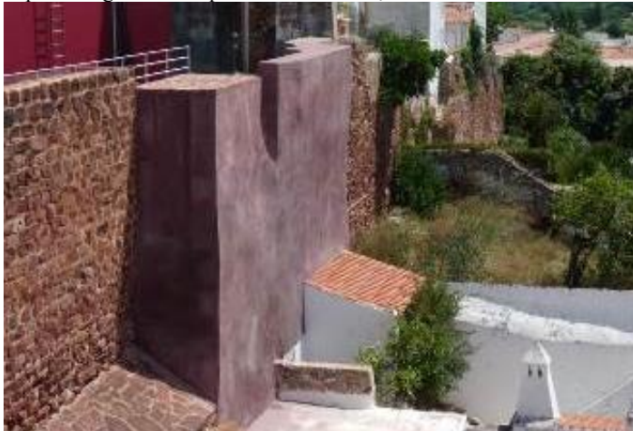
Torre 16. No interior maioritariamente construída em pedra calcária uma vez que a sua reconstituição ao longo dos tempos foi realizada com o reaproveitamento de pedra de outros lados. Intervenção de Conservação e Restauro realizada em 2014 com a aplicação de revestimento com argamassa à base de cal. Fotografia do arquivo do SCR/CMS, 2018.
