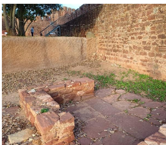
Acumulação de folhas e pedras de grés armazenadas no local errado. Fotografia do arquivo do SCR/CMS, 2024.
