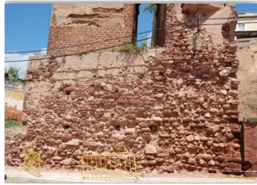
Figura 91: Proteção para os transeuntes da área em risco de derrocada devido ao risco de destacamento de elementos pétreos e taipa. Fotografia do arquivo do SCR/CMS, 2019.
