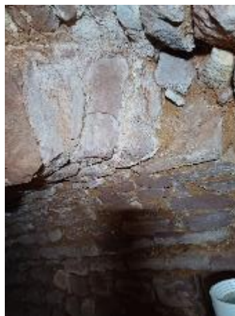
Fratura de elementos pétreos. Fotografia do arquivo do SCR/CMS, 2024.
