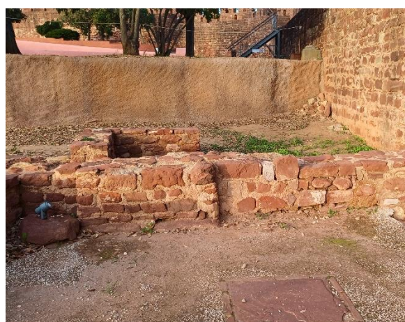
Risco de destacamento de elemento pétreo. Fotografia do arquivo do SCR/CMS, 2024.
