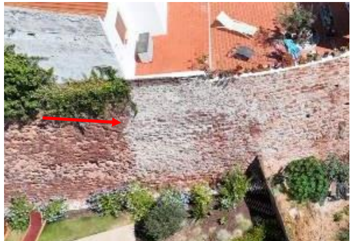
Tramo de muralha S4. Capeamento da muralha original. Alvenaria ordinária com grés de Silves e argamassa à base de cal. Observa-se aplicação descuidada de argamassa branca de intervenção de conservação e restauro realizada em 2022 por empresa privada. Fotografia do arquivo do SCR/CMS, 2024.
