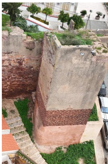
Fotografia do alçado poente da Torre 4. Situação mantém-se. Fotografia do arquivo do SCR/CMS, 2024.
