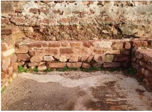
Abertura de juntas, depósitos na base da estrutura resultantes da desagregação das argamassas, elementos pétreos expostos às condições atmosféricas e presença de vegetação. Fotografia do arquivo do SCR/CMS, 2024.
