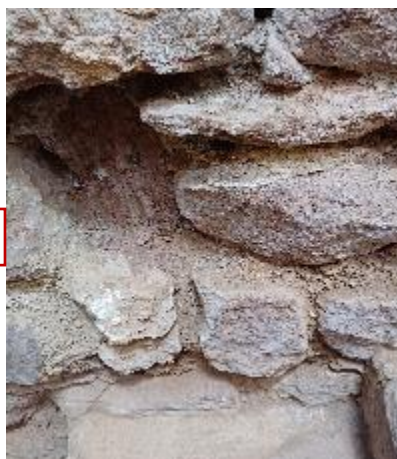
Depósito decorrente de arenização do elemento pétreo e da argamassa de junta. Exemplo do que acontece na generalidade do Poço-Cisterna. Fotografia do arquivo do SCR/CMS, 2024.
