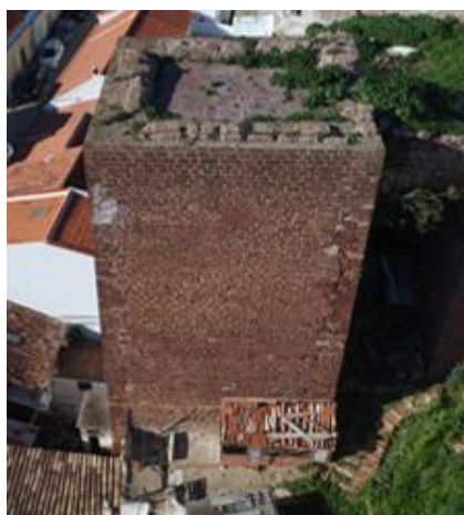
Fotografia do alçado sul da Torre 6. Elemento espúrio, desagregação, lacunas pontuais e fendilhação. EC5.– LEB, 2017.
