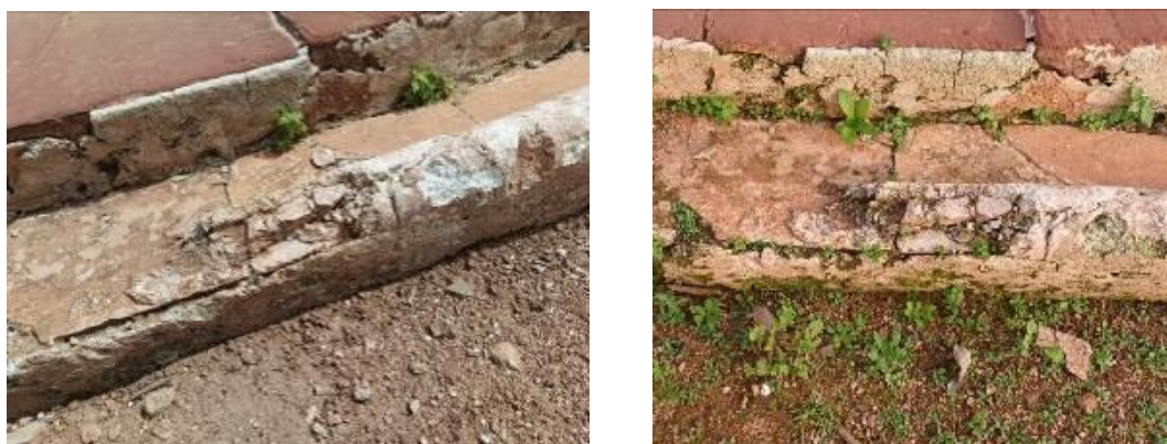
Fendas, fissuras, risco e destacamento do estuque, ausência de argamassas e aumento da colonização biológica. Fotografias do arquivo do SCR/CMS, 2023 à esquerda e 2024 à direita.
