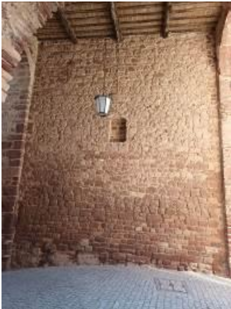
Alçado sul no interior dos arcos: erosão das juntas e dos elementos pétreos, alveolização, pulverulência das juntas e dos elementos pétreos e risco e destacamento de elementos pétreos. Fotografia do arquivo do SCR/CMS, 2024.
