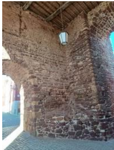
Alçados norte e nascente no interior dos arcos: erosão das juntas e dos elementos pétreos, alveolização, pulverulência das juntas e dos elementos pétreos e risco e destacamento de elementos pétreos. Fotografia do arquivo do SCR/CMS, 2024.
