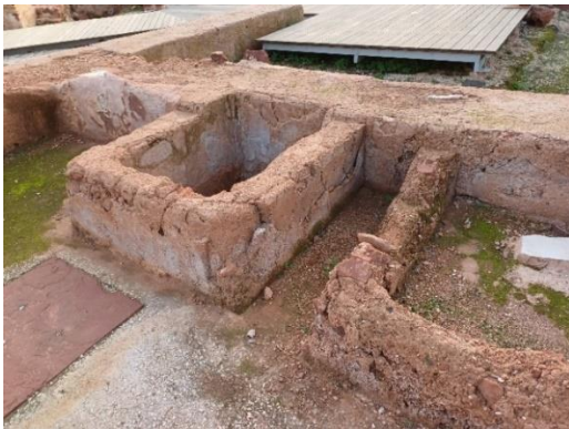
Fendas, fissuras, risco e destacamento na estrutura em taipa. Fotografia do arquivo do SCR/CMS, 2004.
