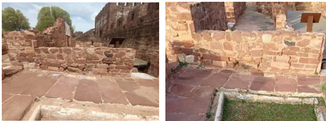
Abertura de juntas. Fotografias do arquivo do SCR/CMS, 2023 à esquerda e 2024 à direita.
