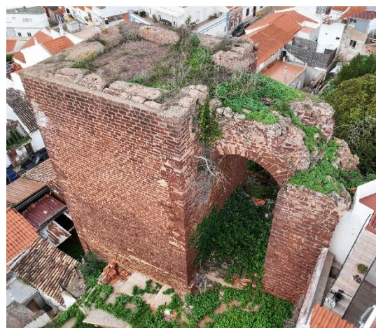
Fotografia do alçado sul da Torre 6. Elemento espúrio removido, desagregação da argamassa e presença elevada de colonização biológica EC5. Situação mantém-se. Fotografia do arquivo do SCR/CMS, 2024.
