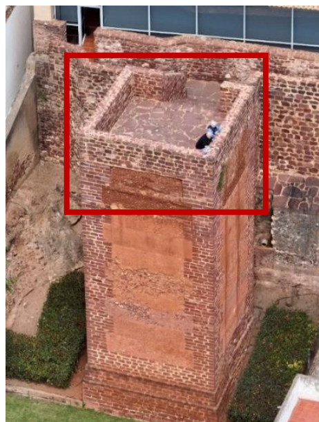
Figura 53: Identificação da zona com os principais problemas estruturais da torre 17. Fotografia do arquivo de SCR/CMS, 2024.
