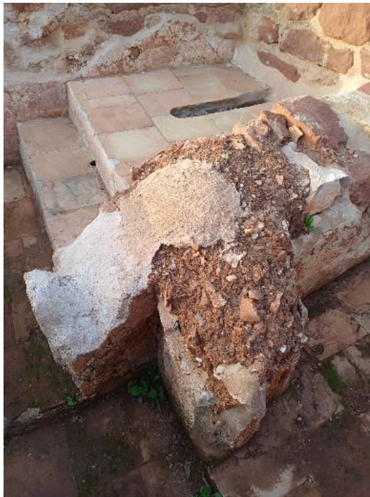
Zona de taipa pulverulenta e em risco de destacamento. FotografiaS do arquivo do SCR/CMS, 2024.
