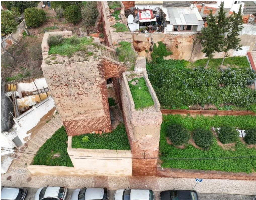
Presença de vegetação e lixo que impedem a passagem para a área superior da Torre 4. Não se observam, à vista desarmada, alterações do estado de conservação. Fotografia do arquivo do SCR/CMS, 2024.
