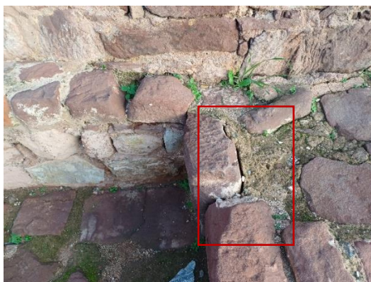
O SCR foi alertado pelo Segurança do Castelo que o elemento pétreo assinalado encontra-se em risco de destacamento. Dano relacionado com o facto de os visitantes passarem por cima das estruturas para acederem ao passeio de ronda e vice-versa. Fotografias do arquivo do SCR/CMS, 2024.
