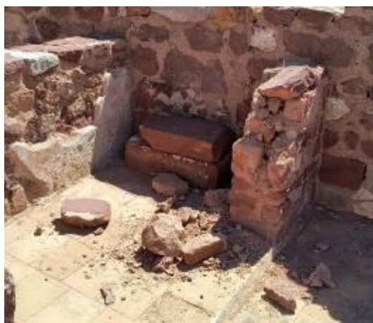
Desabamento da área superior da estrutura. Fotografia do arquivo do SCR/CMS, 2024.
