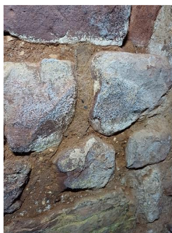
Aumento sazonal da eflorescência de sais, contudo, ainda de forma muito pontual. Fotografia do arquivo do SCR/CMS, 2024.
