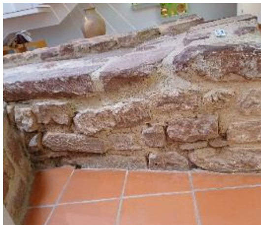
Exemplo de fissuras na argamassa de juntas. Fotografia do arquivo do SCR/CMS, 2024.
