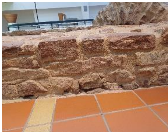
Abertura de juntas provocada pela frequente desagregação das argamassas existentes. Zona exterior do monumento, intervencionada nos anos 80. Fotografia do arquivo do SCR/CMS, 2024.
