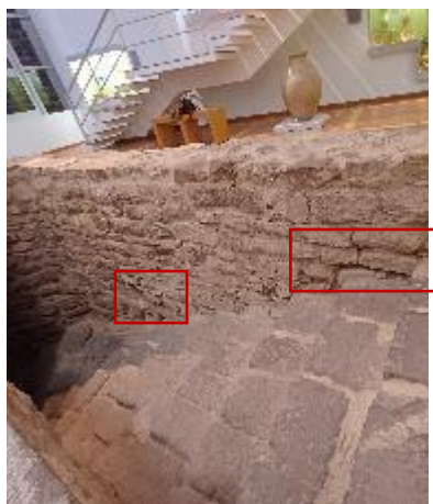
Destacamento de elemento pétreo e abertura de juntas nas escadas de acesso. Fotografia do arquivo do SCR/CMS, 2024.
