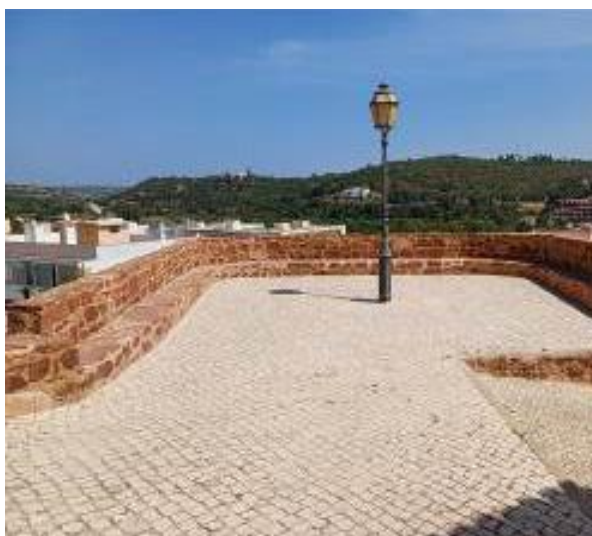
A intervenção de conservação e restauro da Torre 15 foi realizada de 09-12/2023 pelo SCR. Presença de sais devido à temperatura elevada e humidade baixa. Fotografia do arquivo do SCR/CMS, 2024.
