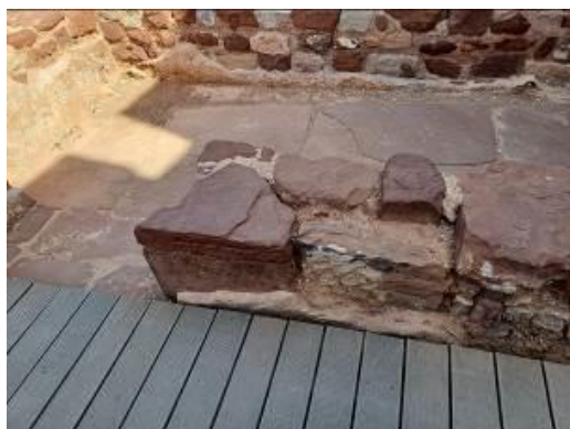
Risco de destacamento de elemento pétreo. Fotografias do arquivo do SCR/CMS, 2024.
