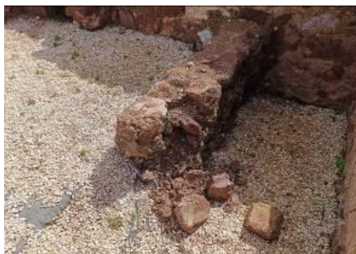
Desmoronamento pontual de alvenaria. Fotografia do arquivo do SCR/CMS, 2024.
