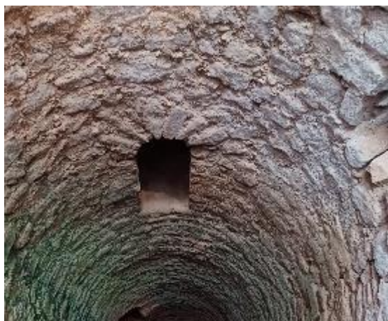
Vãos 2 e 3. Ausência de argamassa na periferia do vão 2. Fotografia do arquivo do SCR/CMS, 2024.
