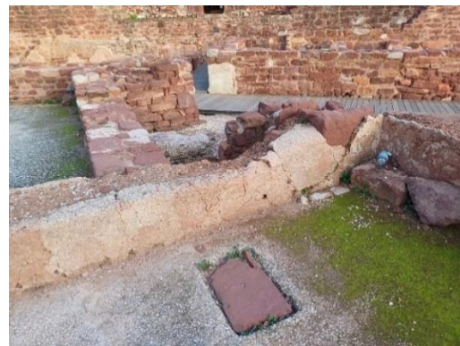
Fendas, fissuras, risco e destacamento da camada de sacrifício. Fotografia do arquivo do SCR/CMS, 2004.
