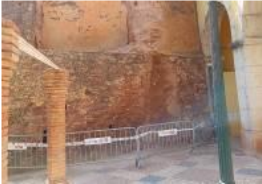
Figura 90: Proteção para os transeuntes da área em risco de derrocada devido a fissura e destacamento de elementos pétreos e taipa. Fotografia do arquivo do SCR/CMS, 2024.
