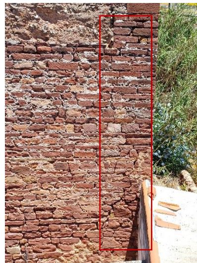
Pormenor da fissura no alçado norte da Torre 5. Fotografia do arquivo do SCR/CMS, 2024.
