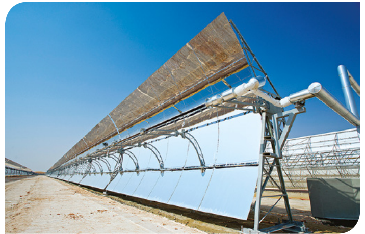
Figura 6 Instalação para a produção de eletricidade solar térmica com coletores cilíndrico-parabólicos (Masdar Official, CC BY-SA 2.0 < https://creativecommons.org/licenses/by-sa/2.0/ >, via Wikimedia Commons).
