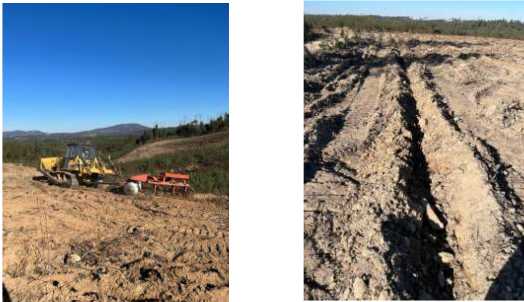
Figura 6. Gradagem (imagem à esquerda) e abertura de vala de plantação com ripper (imagem à direita).
