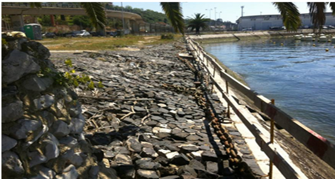
Figura 15 – Assentamento do terrapleno, no sentido transversal
