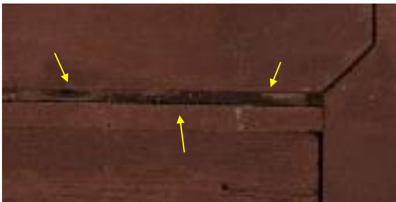
Figura 40 – Pormenor de uma trave perimental na extremidade superior direita da tábu (assinalado a amarelo), C.F.: Gonçalo de Figueiredo
