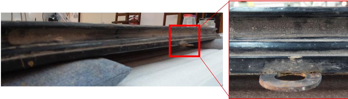
Figura 50 – Acumulação de pó na moldura e respetivo pormenor, A.P.
