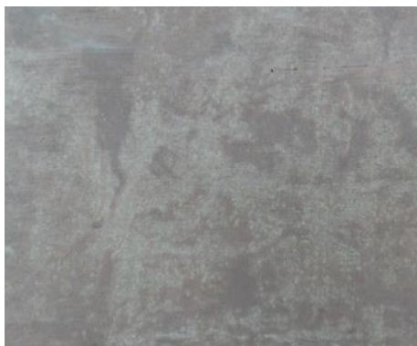
Figura 42 – Detalhe de manchas brancas de humidade da zona esquerda do verso do painel superior, A. P.
