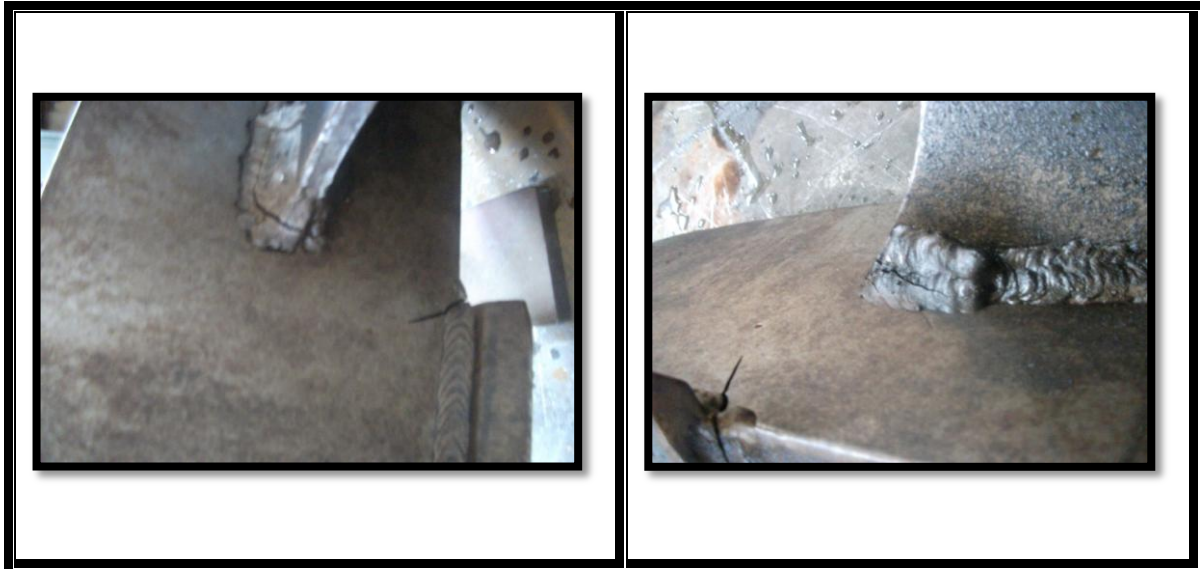
Figura 4.25. Reconstrução processador/Quebra estrutural chassi dos motores
