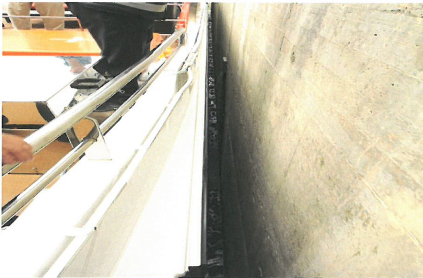
Figura 44 – Inexistência de defensas no interior e entrada das caldeiras das eclusas.
