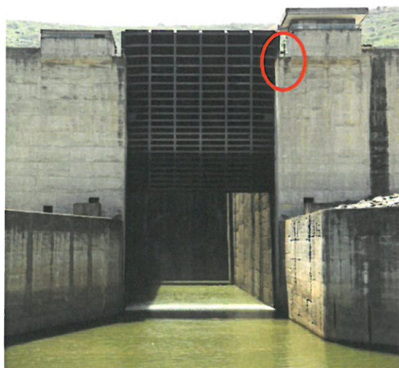
Figura 13 – Semáforo de sinalização da entrada da eclusa (Fotografia cedida pelo IH - CFR Maurício Camilo)
