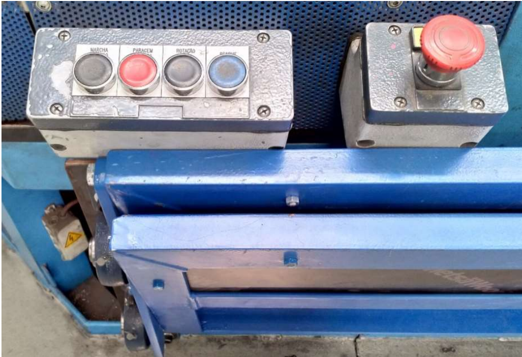
Figura 3.3.9 – Interferência entre os degraus e botoeira de controle
