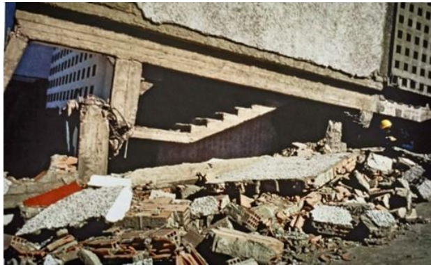
Figura 7. Colapso de um pilar devido à escada.
