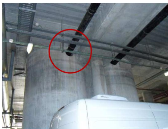
Figura 70 - Tubagem de transporte de água pluvial
