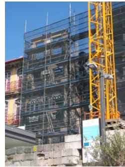
Figura A7.323| P 07, Muro Bacalhoeiros.
