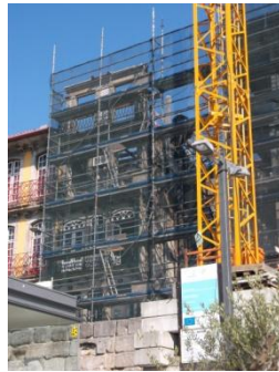
Figura A7.322| P 06, Muro Bacalhoeiros.
