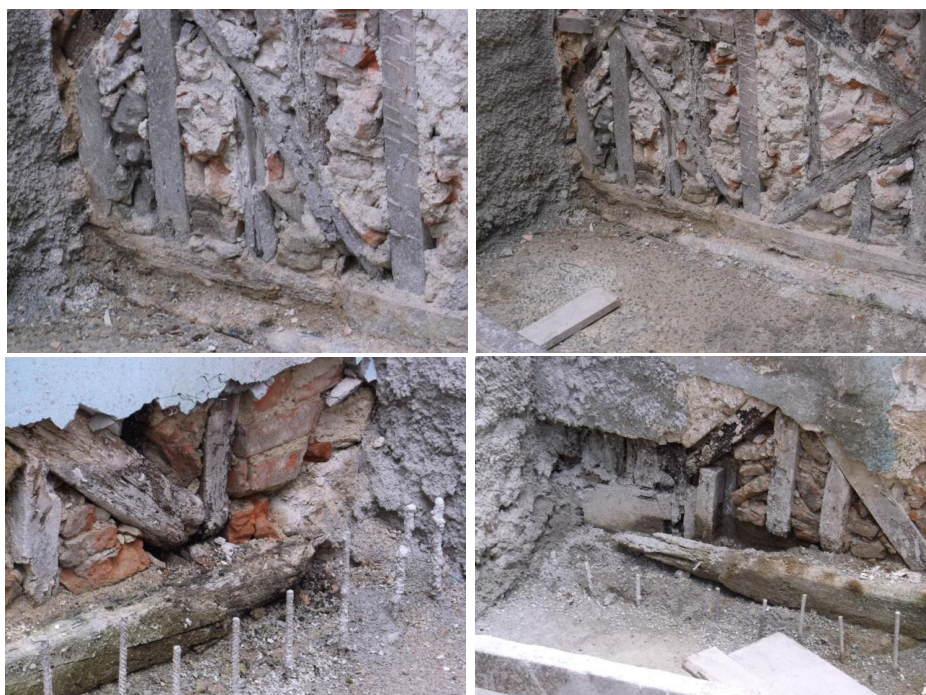
Figura 4.71 | Patologias existentes nas paredes em tabique.
