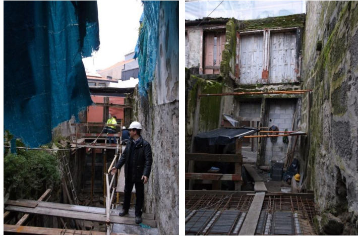
Figura 4.68 | Aspeto das paredes existentes antes do processo de limpeza.
