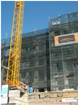
Figura A7.321| P 05, Muro Bacalhoeiros.
