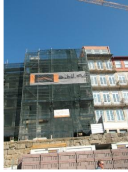
Figura A7.318| P 02, Muro Bacalhoeiros.
