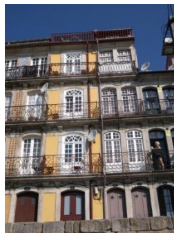
Figura A7.330| P 14, Muro Bacalhoeiros.
