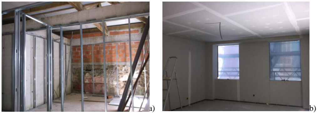
Figura 4.34 | Execução de paredes em gesso cartonado: a) montagem da estrutura metálica; b) acabamento das juntas.
