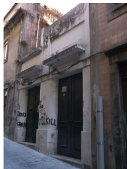
Figura A7.231 | P 35, Rua da Ponte Nova.
