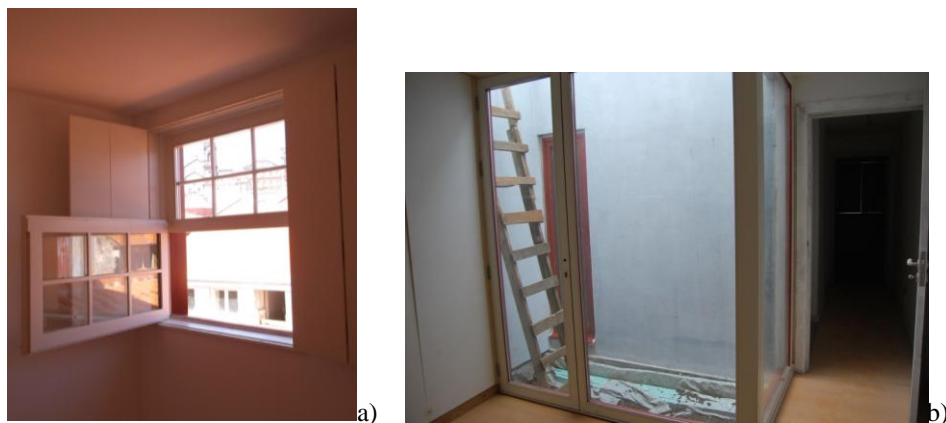
Figura 4.55 | Tipos de caixilharias aplicadas.
