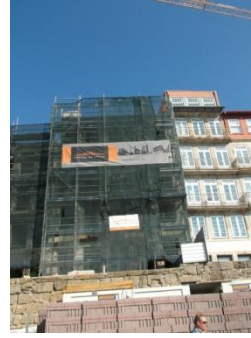
Figura A7.319| P 03, Muro Bacalhoeiros.
