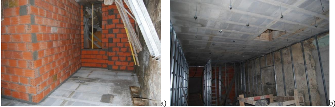
Figura 4.51 | Parede interior: a) em alvenaria de tijolo; b) estrutura autoportante para as paredes interiores em gesso cartonado/ viroc [01].
