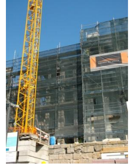
Figura A7.320| P 04, Muro Bacalhoeiros.
