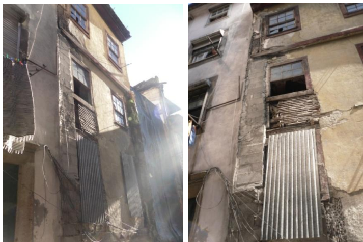
Figura 4.8 | Fachada da parcela 3, em tabique, antes de ter colapsado ( cedido pela Arq. a Ana Leite ).
