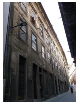
Figura A7.131 | P 16, Rua da Ponte Nova.
