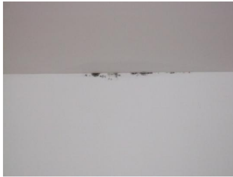
Figura 4.57 | Mancha de bolor na parede do quarto tardoz do último piso.
