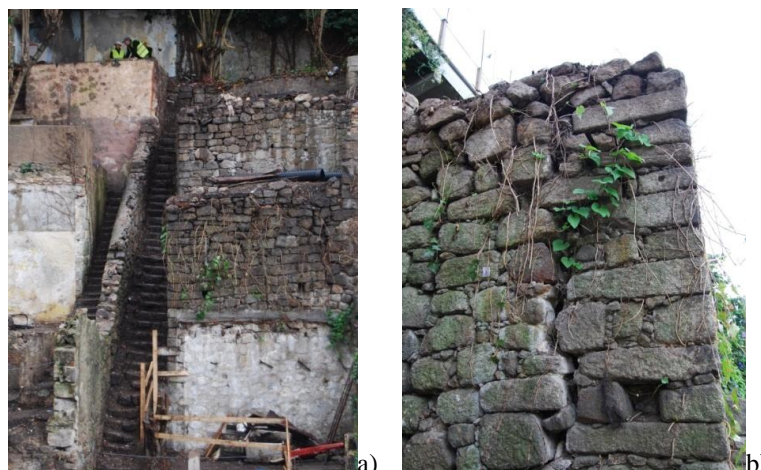
Figura 4.36 | Logradouro: a) durante os trabalhos de limpeza e escoramento; b) exemplo das fissuras existentes nos muros de pedra.
