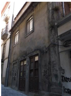
Figura A7.230 | P 34, Rua da Ponte Nova.
