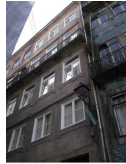
Figura A7.76 | P 24, Travessa da Bainharia.
