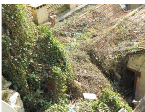
Figura 4.9 | Estado da cobertura antes da demolição ( cedido pela Arq. a Ana Leite ).
