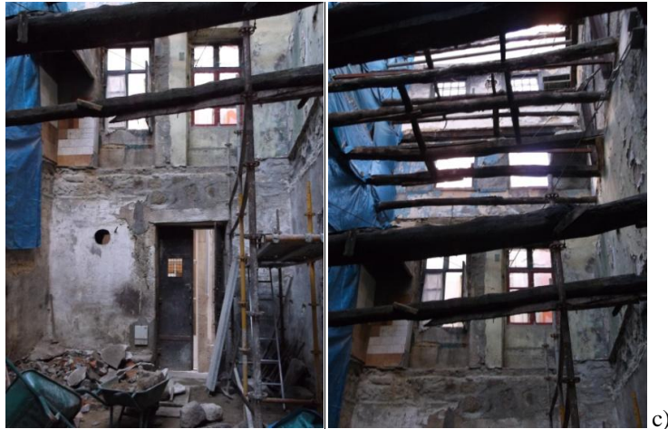
Figura 4.65 Interior das parcelas após os trabalhos de demolição: a) parcela 12; b) parcela 13; c) parcela 14.
