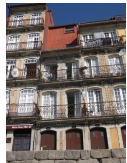
Figura A7.332| P 16, Muro Bacalhoeiros.
