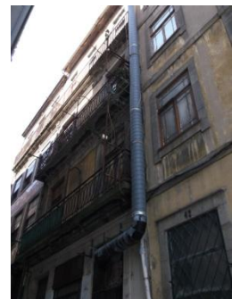
Figura A7.233 | P 37, Rua da Ponte Nova.
