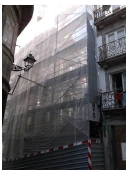
Figura A7.235| P 02, Travessa da Bainharia.
