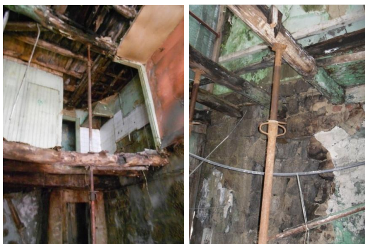
Figura 4.10 | Interior das parcelas, com os vigamentos em madeira dos pisos e cobertura danificados ( cedido pela Arq. a Ana Leite ).
