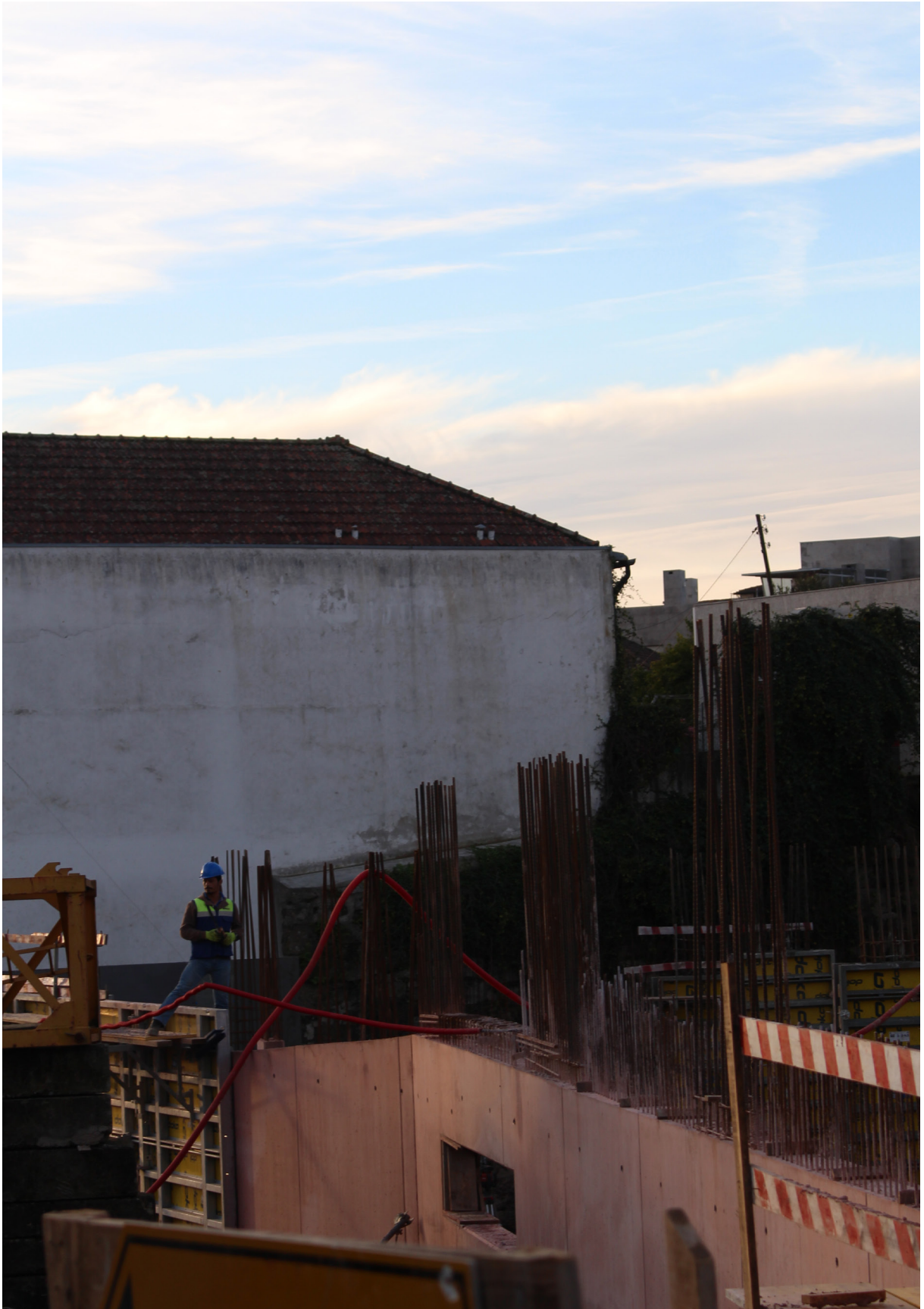
Fig. 42 Aqui o trabalhador encontra-se numa situação de grande perigo, pois na falta de uma estrutura onde possa estar em segurança, este segura-se de forma instável entre um muro e um taipal.
