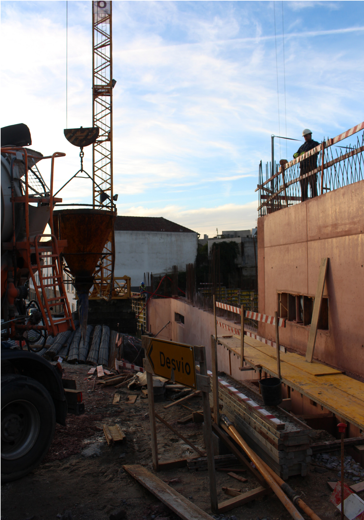
Nesta foto podemos observar que não estão a ser cumpridas as normas de limpeza e organização da obra, que permitem uma circulação segura de pessoas e materiais.
