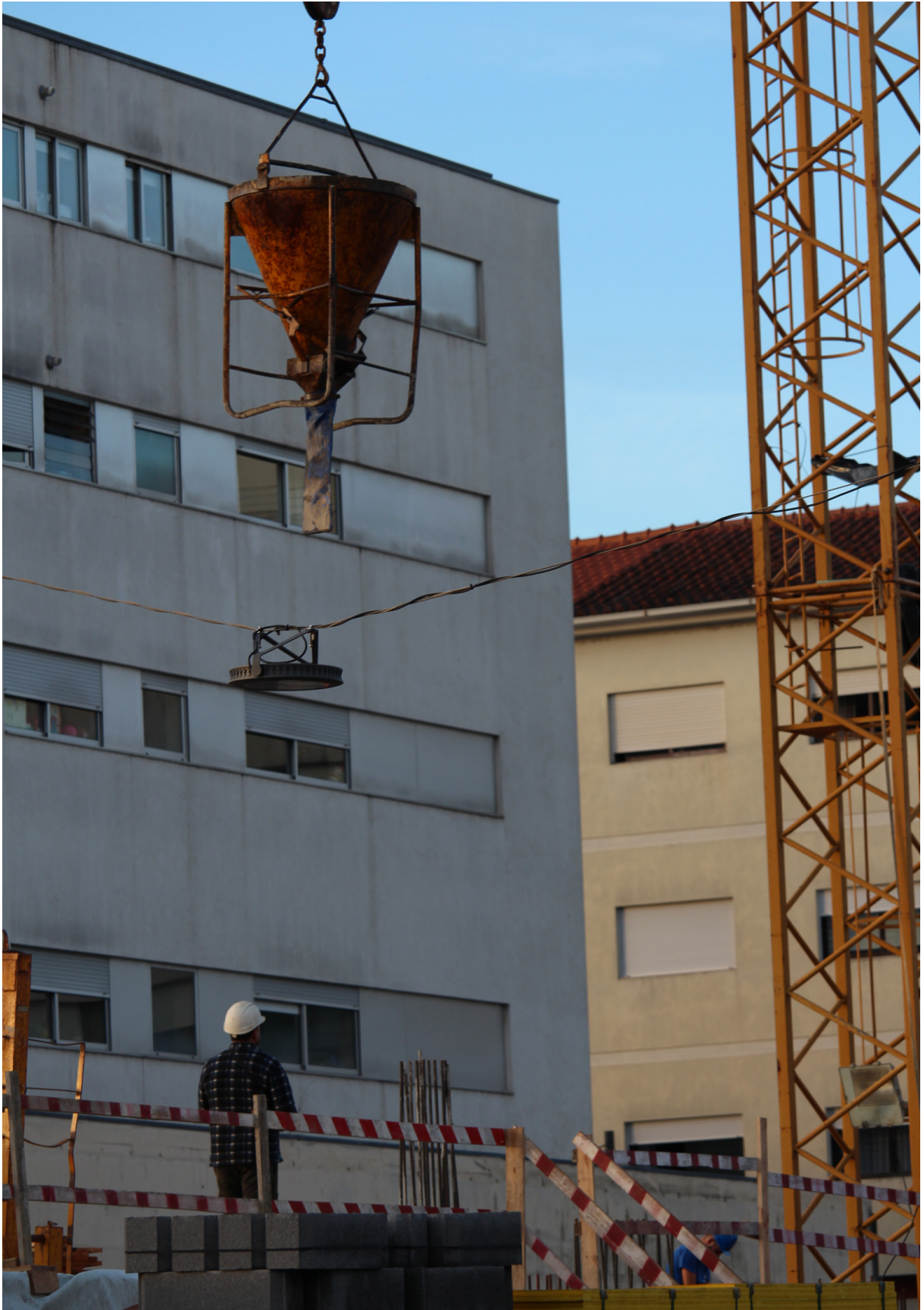
Fig. 44 Nesta fotografia é identificada uma situação indesejavelmente recorrente. Numa obra os trabalhadores nunca se podem posicionar debaixo de qualquer objeto suspenso pela grua.
