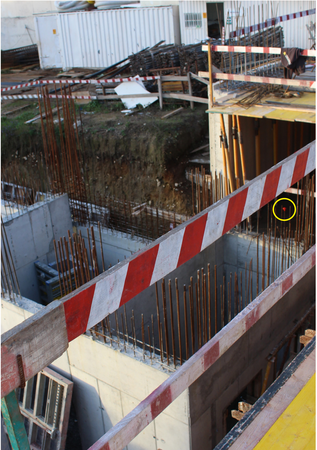
Fig. 33 Na área assinalada pelo círculo amarelo pode-se ver uma proteção vermelha que deveria estar colocada nas extremidades de todos os ferros estruturais e que está em falta na maioria deles.
