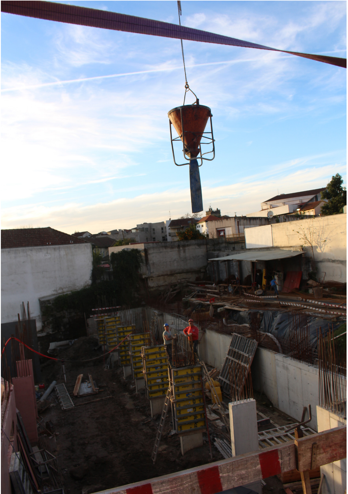
Fig. 36 Nesta foto pode-se ver os trabalhadores a efetuar o enchimento de um pilar sem qualquer proteção, numa escada que não tem o comprimento adequado e apoiados em ferros, quando esta é uma atividade que exige a montagem de uma estrutura prévia que garanta a sua segurança.
