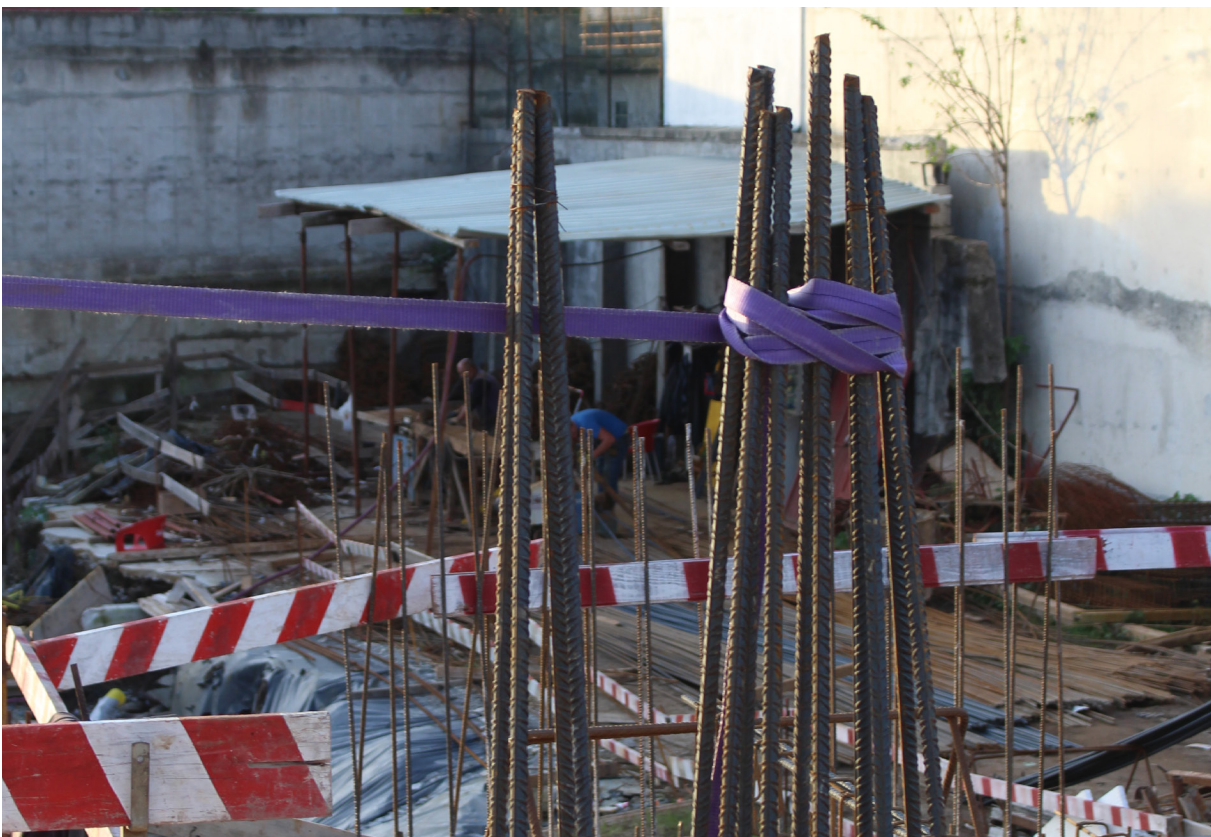
A linha de vida aqui fotografada (fita lilás), que tem como objetivo proteger os trabalhadores de uma eventual queda de desnível, está instalada de uma forma inadequada e, insegura.
