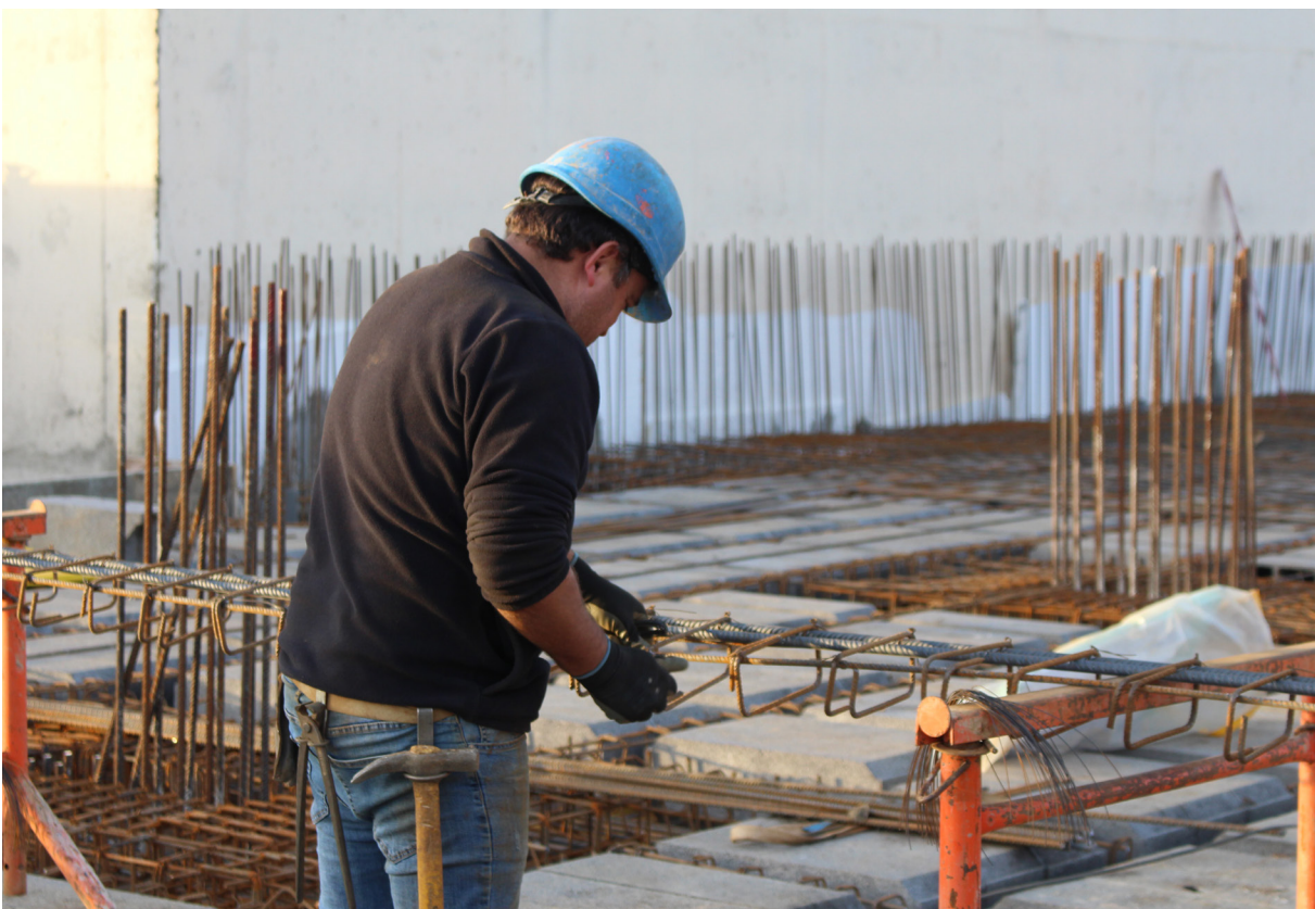
Embora não tenha sido captado, os trabalhadores encontravam-se neste momento a cortar com a rebarbadora sem os EPI's necessários para assegurar a sua proteção total, estando em falta a proteção ocular e auditiva.
