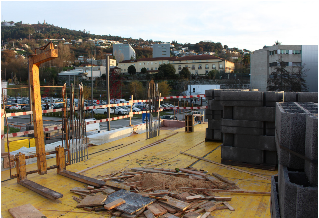
Fig. 40 Na Fig.39 e 40 é visível uma desorganização que pode ser a causa de vários acidentes. Numa obra o espaço deve estar sempre limpo e os 'caminhos' desobstruídos.
